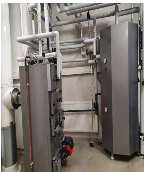
Kuva 6. Kaksoispesäkattila ja varaaja
