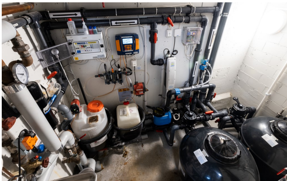
Kuva 16. Laittila automatiikalla ja kahdella suodattimella [18]
