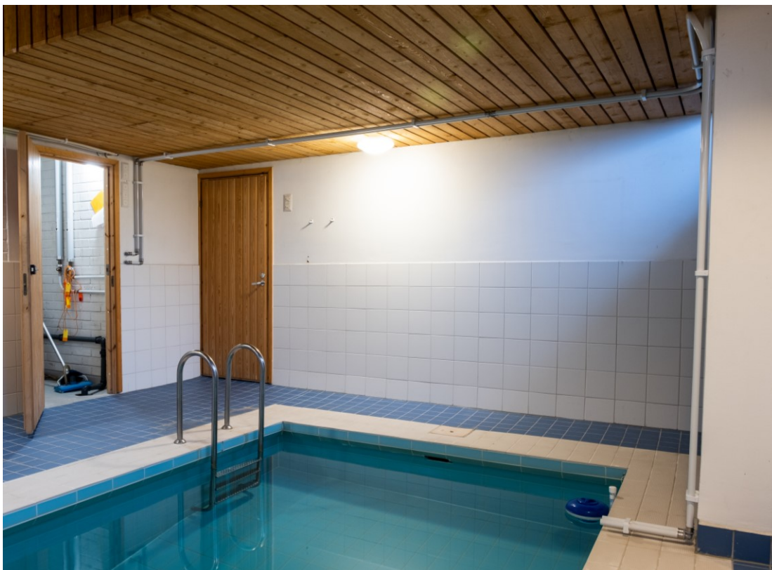
Kuva 17. Uima-altaan kiinteä täyttöputki [18]
