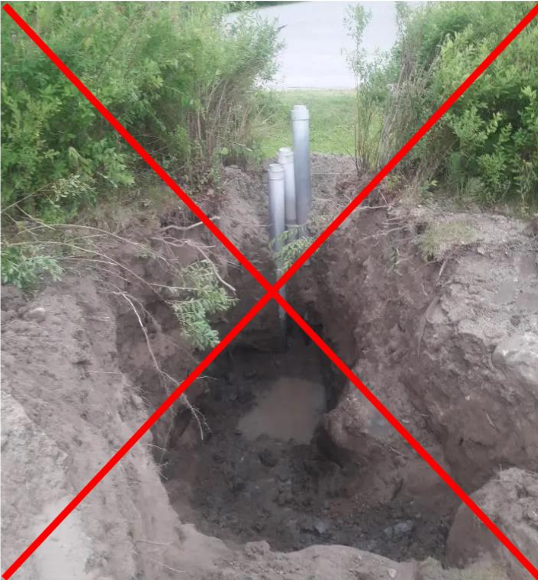
KUVA 35. Kaivanto, jossa ei ole turvallista työskennellä.
