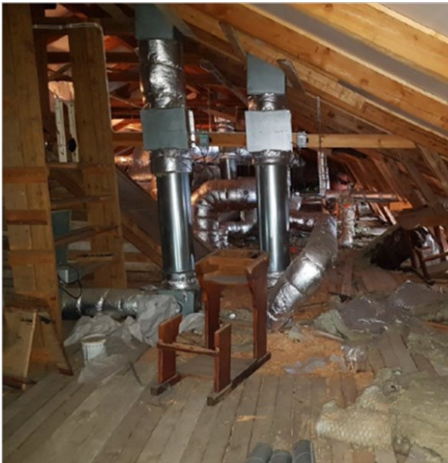
KUVA 19. Myös A-osalla eristeenä on purua. Purun päällä harvalaudoitus. Yläpohjassa on paljon talotekniikan pysty- ja vaakavetoja, jotka on eristetty. Lisäksi yläpohjassa on rakennusmateriaaleja sekä vanhoja kalusteita ym. sekalaista tavaraa ja materiaaleja. (Kuopion kaupunki, Opinnäytetyön taustaineisto 07 TUTKIMUKSET_KARTOITUKSET).
