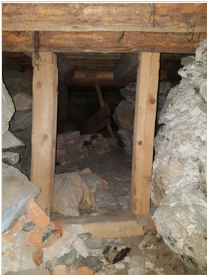
KUVA 16. Rakennuksen B-osan alapohjaan on jätetty orgaanista ainetta rakennusvaiheessa. Lisäksi alapohjan tuentaa on korjattu jälkikäteen. (Kuopion kaupunki, Opinnäytetyön tausta-aineisto 07 TUTKIMUKSET_KARTOITUKSET).
