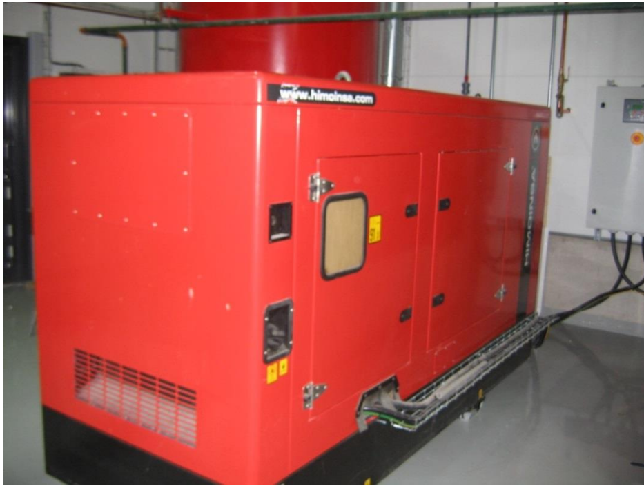
Kuva 10. Varavoimageraattori (Kuva: Atte Mönkäre)
