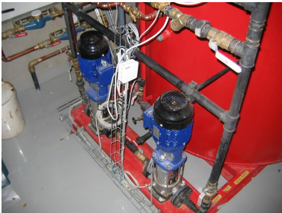
Kuva 9. Paineenkorotuspumput (Kuva: Atte Mönkäre)
