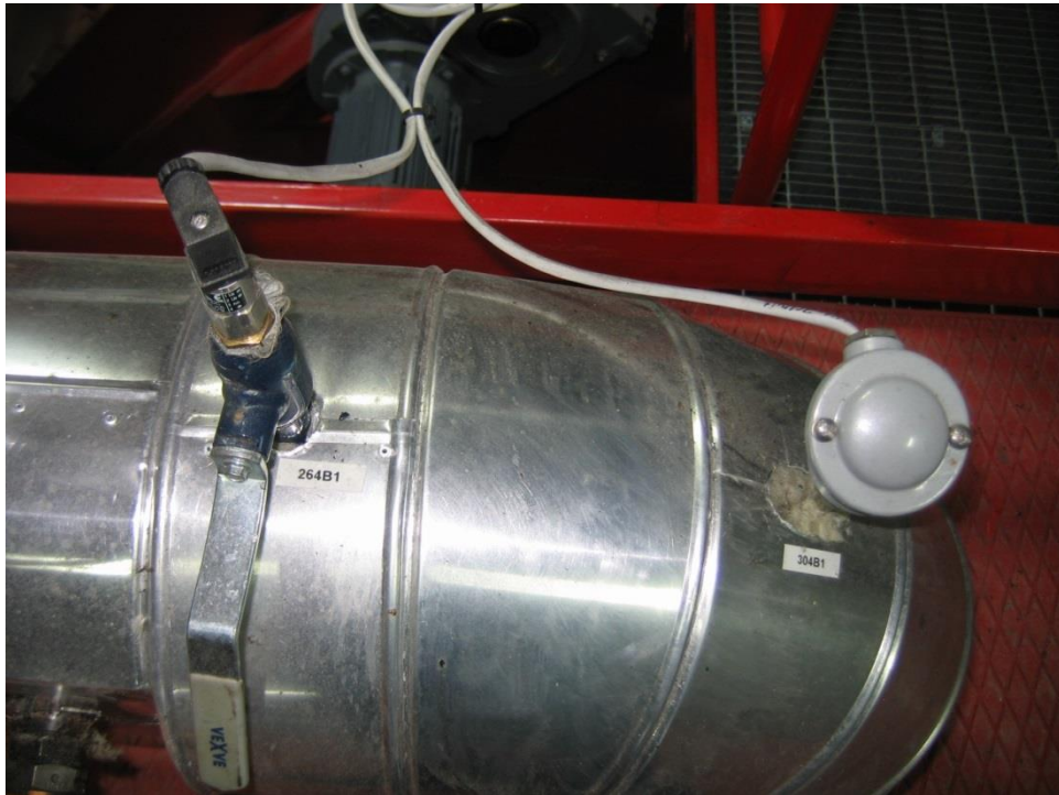
Kuva 5. Trafag Nat 10.0 A -painelähetin ja Termotech PT100 -lämpötila-anturi. (Kuva Atte Mönkäre 2013)
