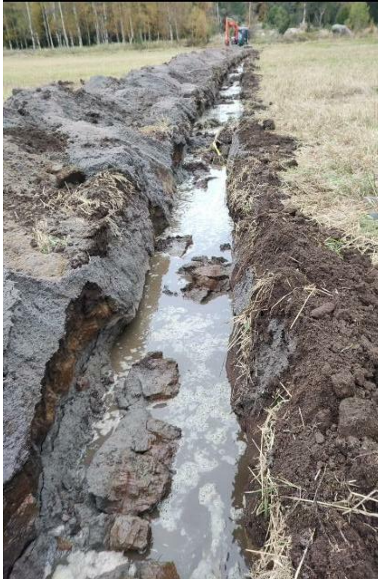
Kuva 10. Kaapelioja, jossa vettä ja sortunutta maata.
