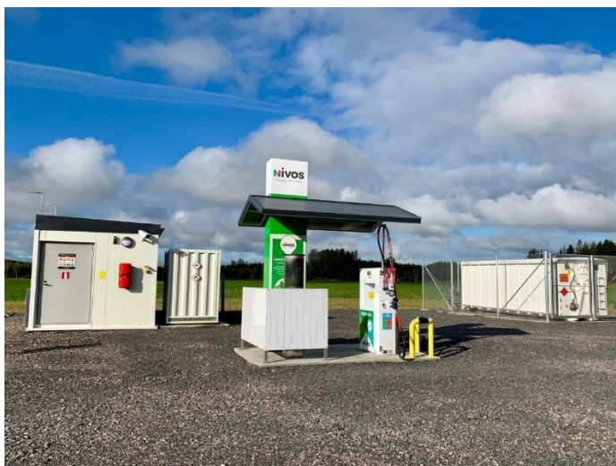
KUVA 13. Metener Oy:n biokaasun tankkausasema (Metener Oy 2022)
