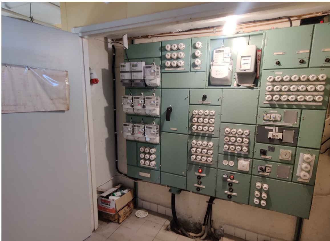
Kuva 10 Kaapelin läpivienti keskushuoneesta 1/2 (Luukkonen, 2022)
