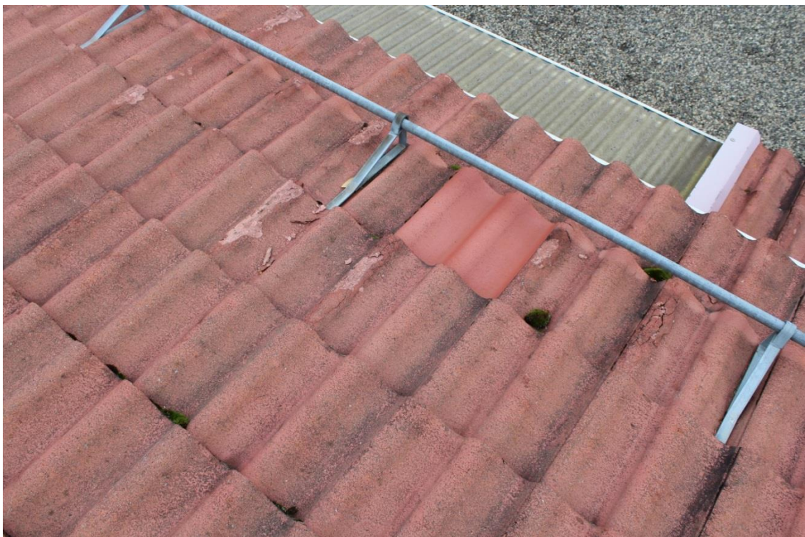
C-talon katon kaikkia vaurioituneita tiiliä ei ole vaihdettu. Ne tulisi vaihtaa
