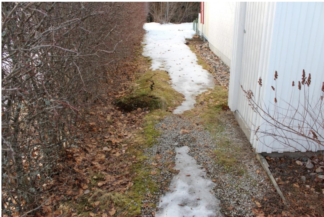
A-talon päädyssä oleva routavaurio
