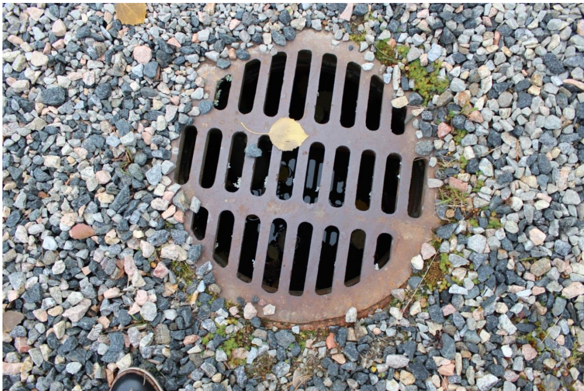
Sadevesikaivoissa on hiekkaa ja sepeliä
