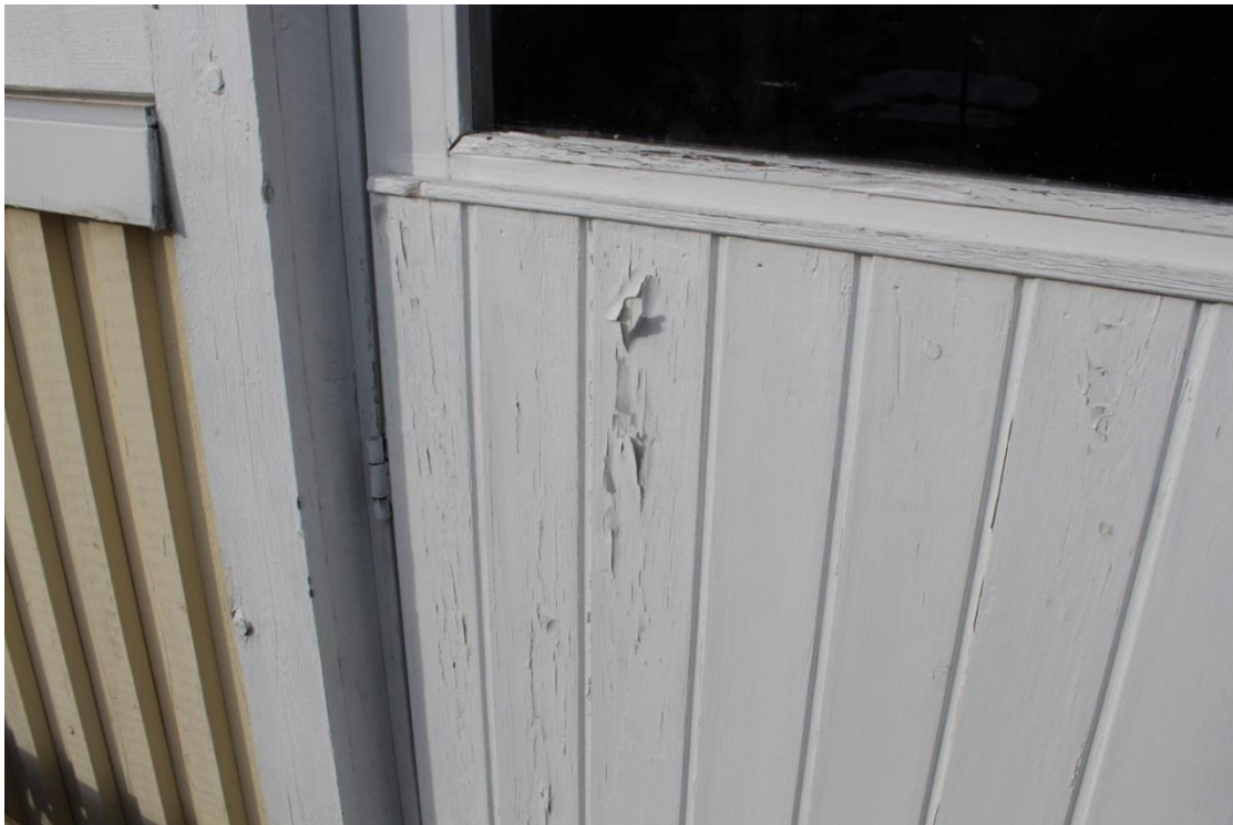
Varastojen ovissa on maali- ja lahovaurioita, ne tulee kunnostaa tai uusia
