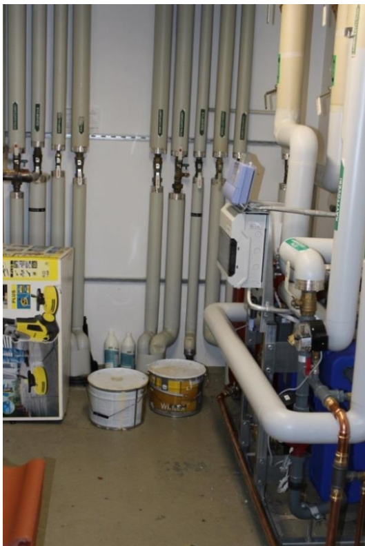
Lämmönjakuhuone, osittain myös varastona
