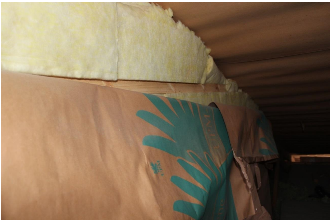
Osan käyttöullakoiden rakenteet ovat epämääräisen näköisiä
