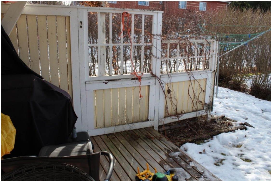
Alkuperäiset väliaidat ovat lahonneita ja huonokuntoisia
