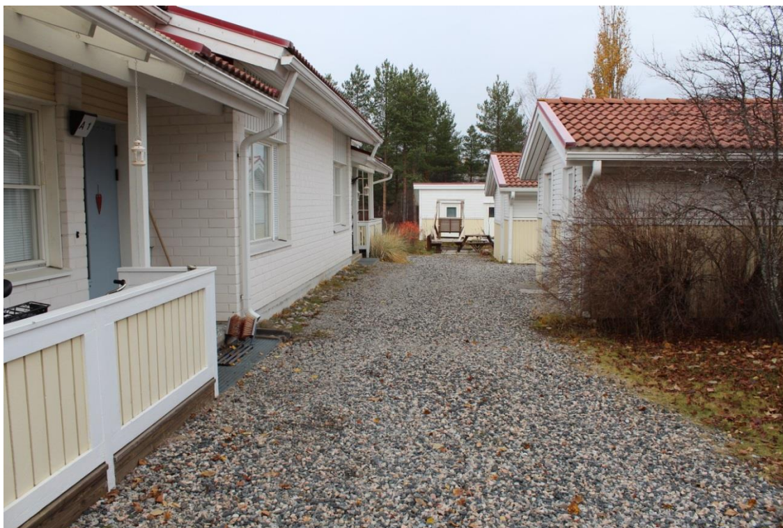
Rakennukset on perustettu turhan matalalle
