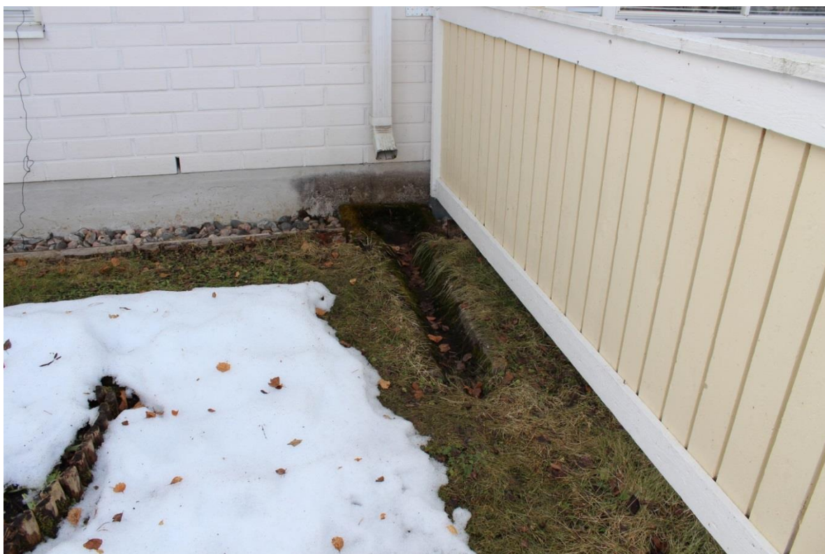
Sulamis- ja sadevesien ohjauksessa on puutteita
