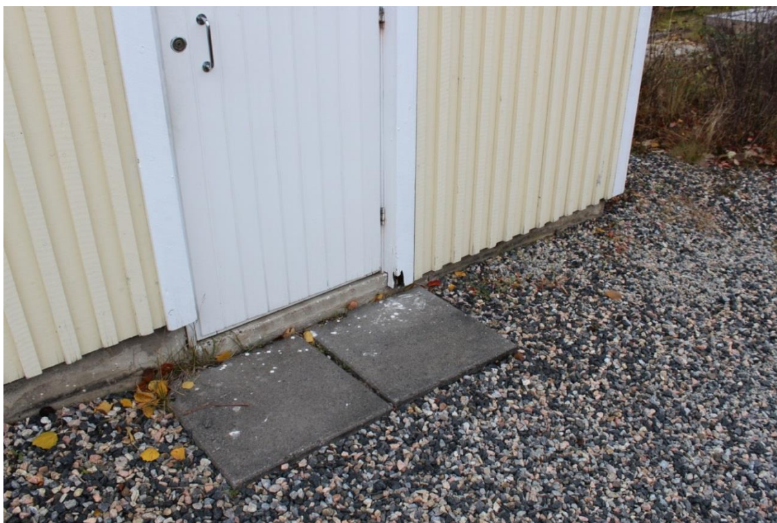
Varastot on perustettu liian matalalle, julkisivuissa on joitakin lahonneita puuverhouslautoja
