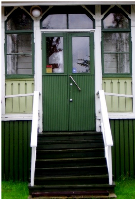
KUVA 9. Ulkoportaattien ennen peruskorjausta. (Savon ICT palvelut Oy julkaisuaika tuntematon)
