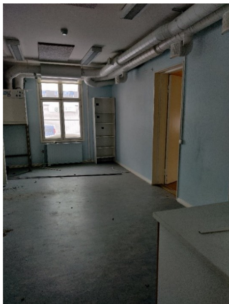
KUVA 14. Taidehuoneen ilmanvaihtoputkisto. (Haatainen 2022)
