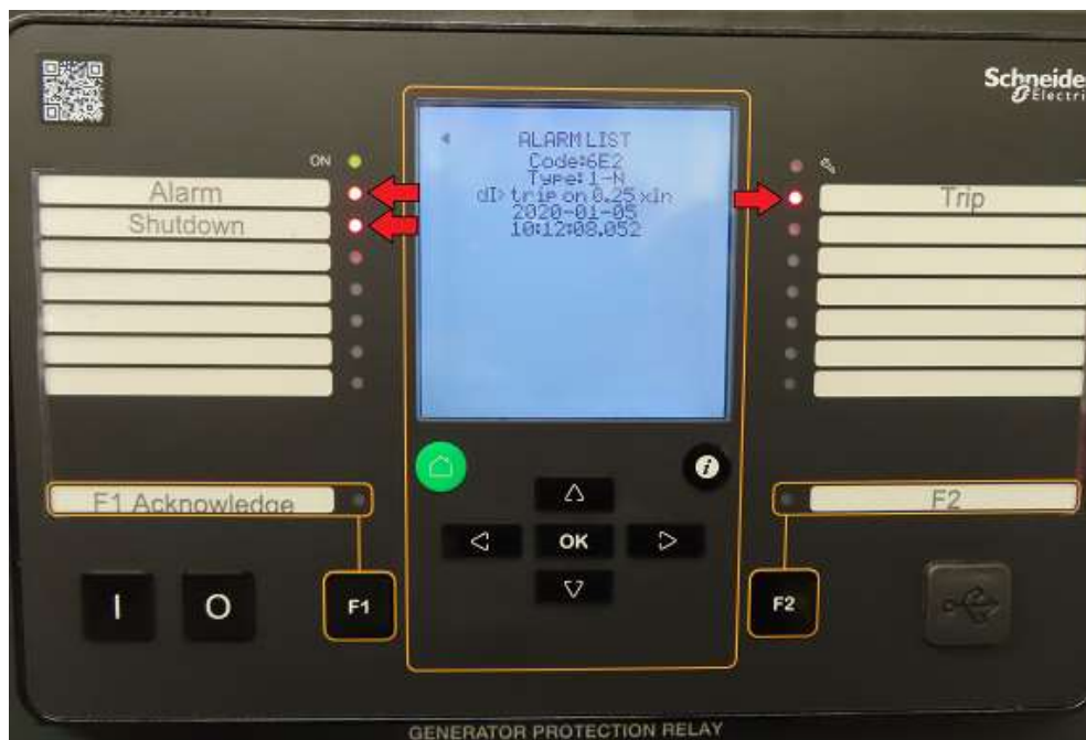
Kuva 11. Suojaustoimintojen indikointi differentiaalisuojalla
