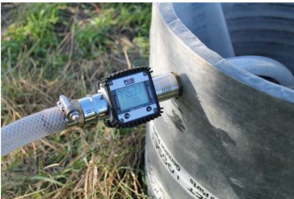
Figur 11. Flödesmätare monterad intill reglerbrunnen, Flödesmätaren visar den aktuella flödesmängden och den totala mängden.
