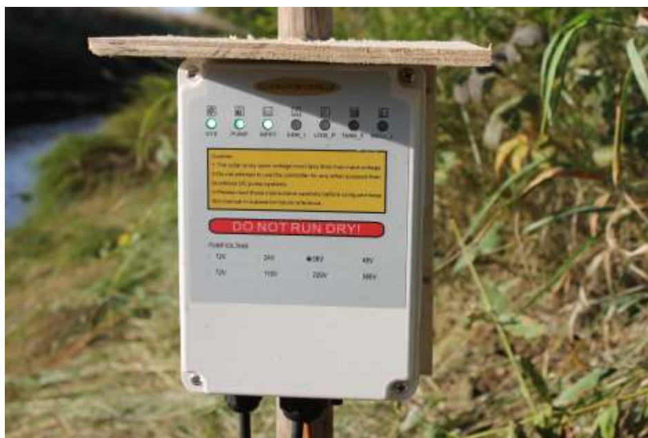
Figur 13. Vattenpumpens regulator under funktion.
