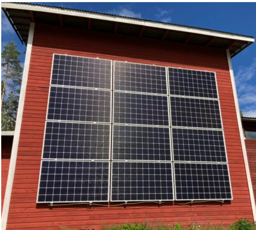
Kuva 8. Aurinkopaneelien seinäasennus (Aurinkovirta.fi 2021).
