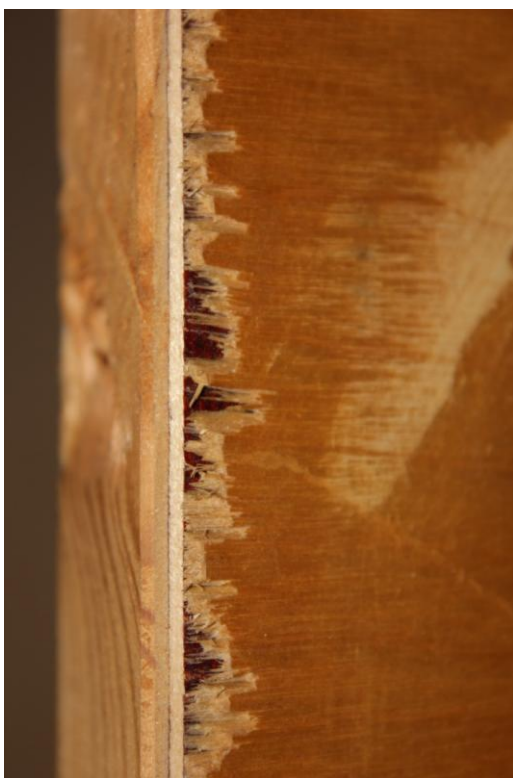
Kuva 9. Oven kaventaminen on vaurioittanut päällimmäistä viilukerrosta ja paljastanut alta ruskeaksi muuttuneen liiman.
