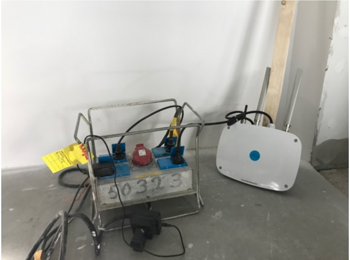
Kuva 8. Vasemmalla työmaan alakeskus ja oikealla työmaalle sijoitettu tukiasema. (27.)
