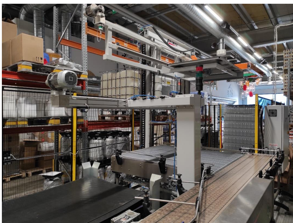
KUVA 13. Pullojen purkukone kuvattuna takapuolelta.
