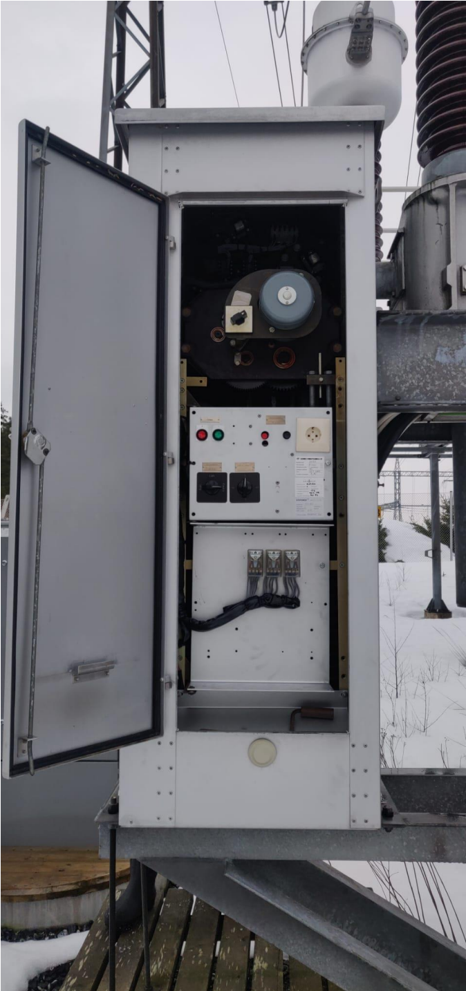
Kuva 16. 110kV katkaisijan ohjaustaulu.
