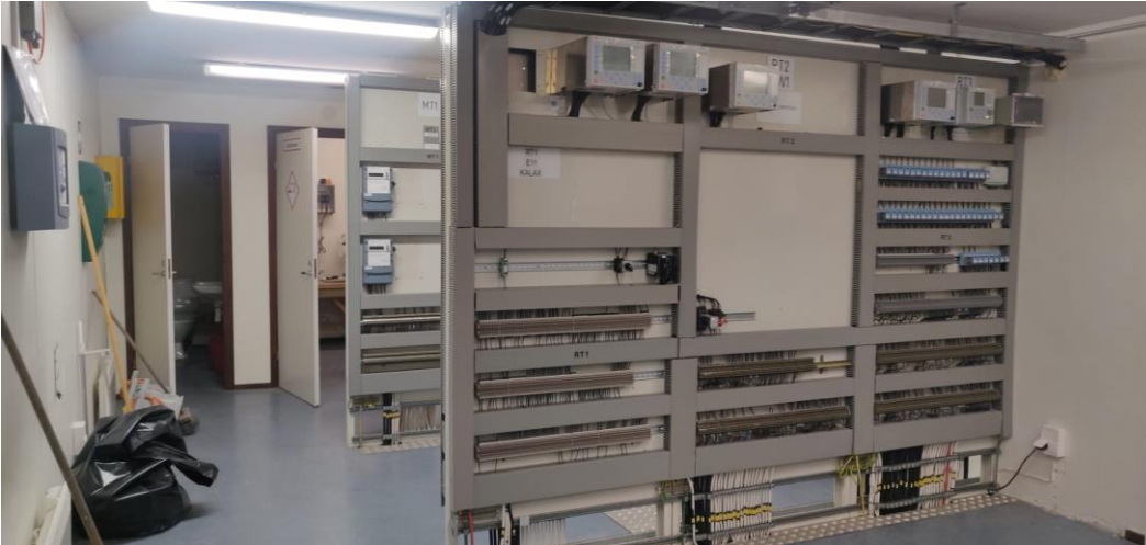
Kuva 13. Närpiön sähköaseman sisätila 2.
