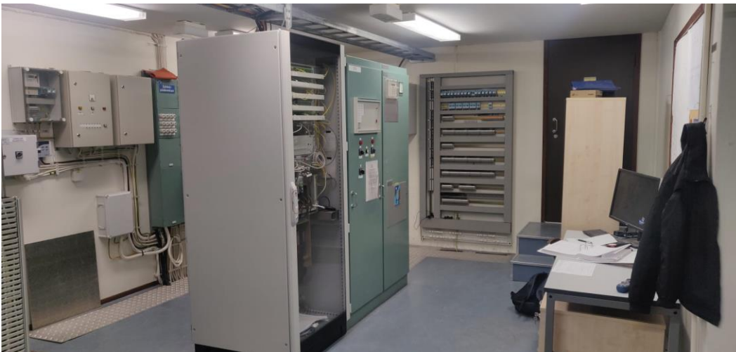
Kuva 12. Närpiön sähköaseman sisätila 1.
