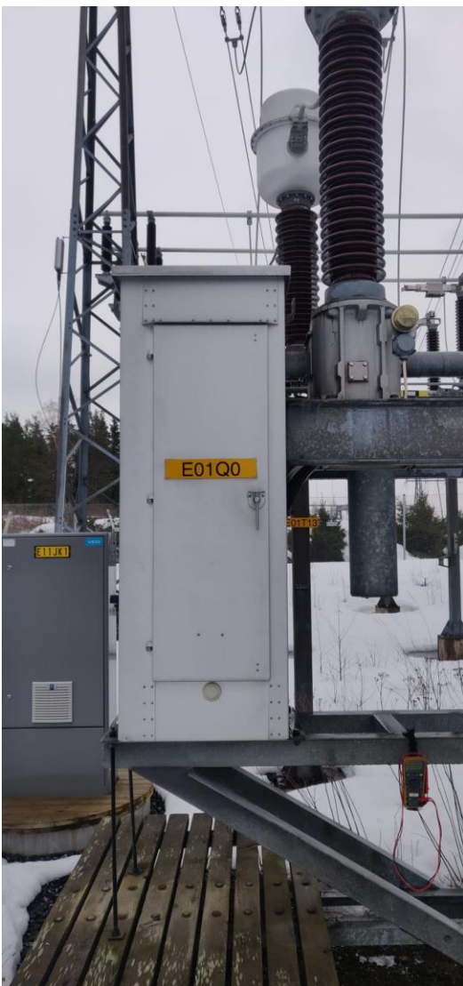
Kuva 15. 110kV katkaisijan ulkopuoli.
