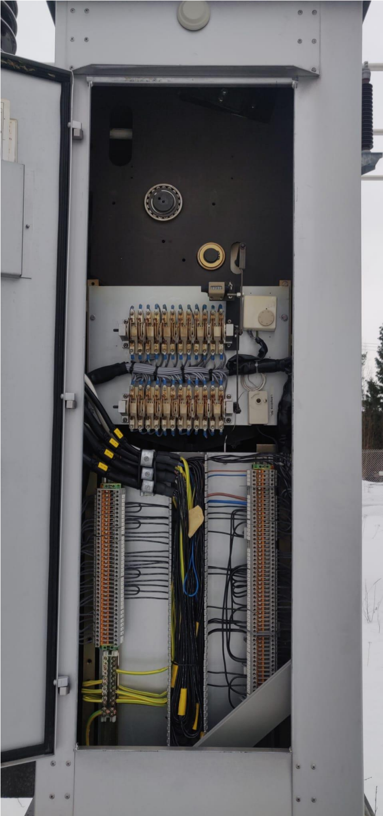
Kuva 18. 110kV katkaisijan johdotukset.
