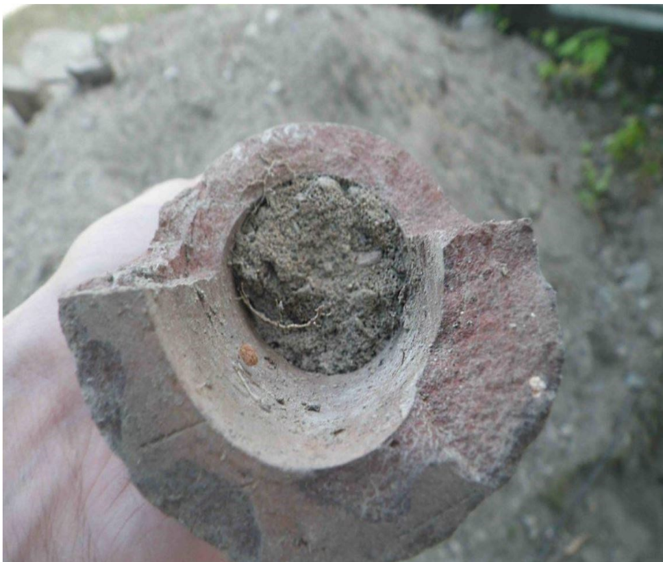
Kuva 4. Maa-aineksella täytynyt tiilisalaojaputki (raksystems.fi)
