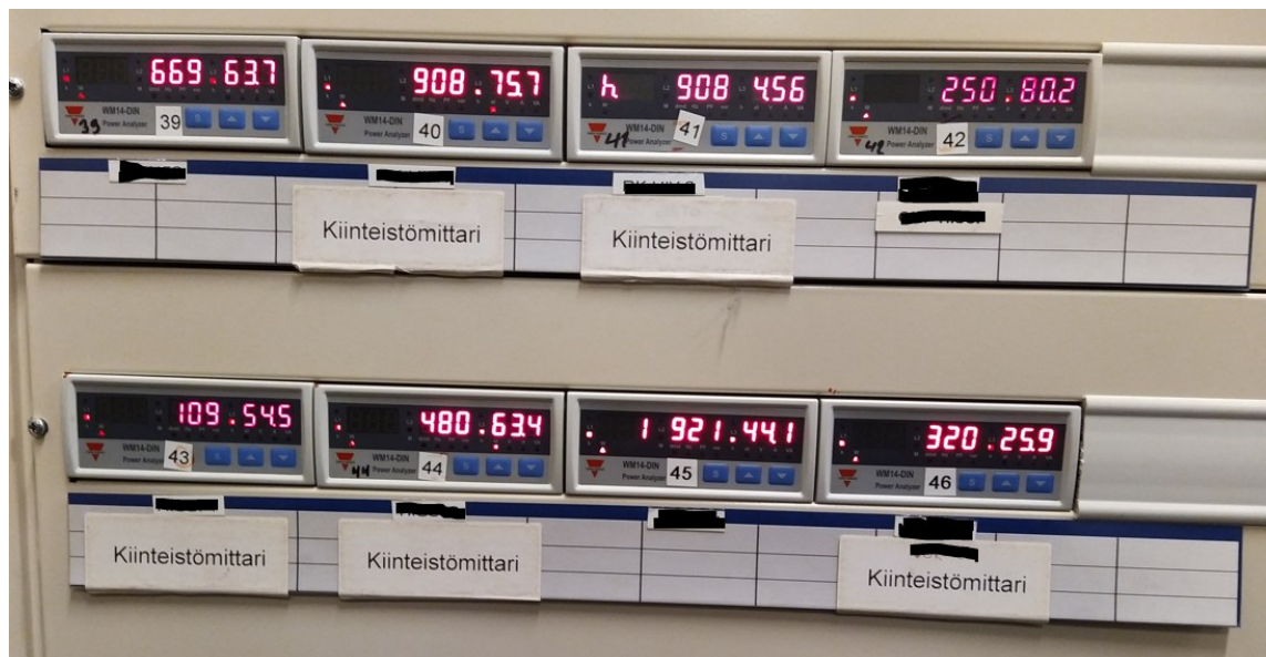
Kuva 10. Carlo Gavazzi WM14-DIN -sähköenergiamittareita.
