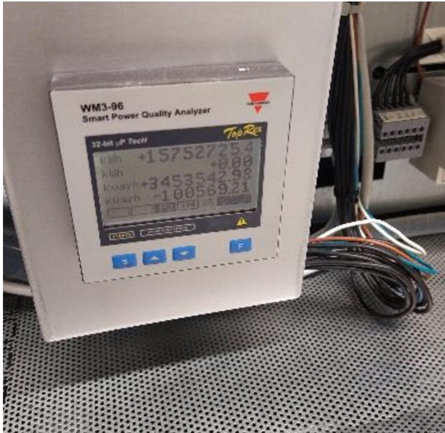
Kuva 11. Carlo Gavazzi WM3-96 -sähköenergiamittari.
