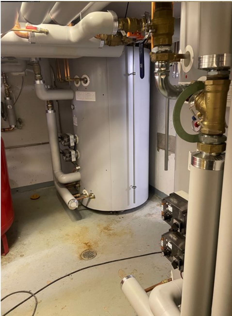
Kuva 7. Sähkövastukset oikealla varaajissa
