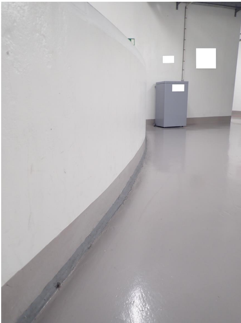
Kuva 2. Liikuntasauva suojarakennuksen seinän ja reaktorirakennuksen lattian välillä (Olkiluoto 2).
