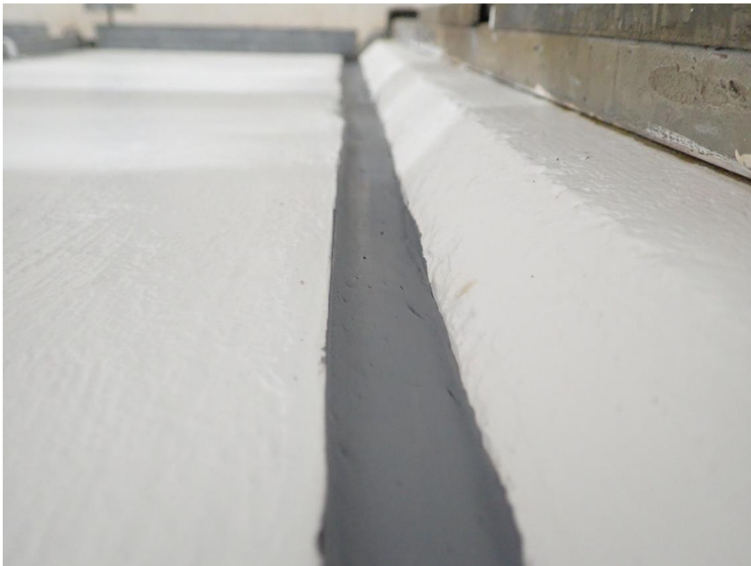
Kuva 1. Liikuntasauama kahden rakennuksen seinien välillä (Olkiluoto 2).
