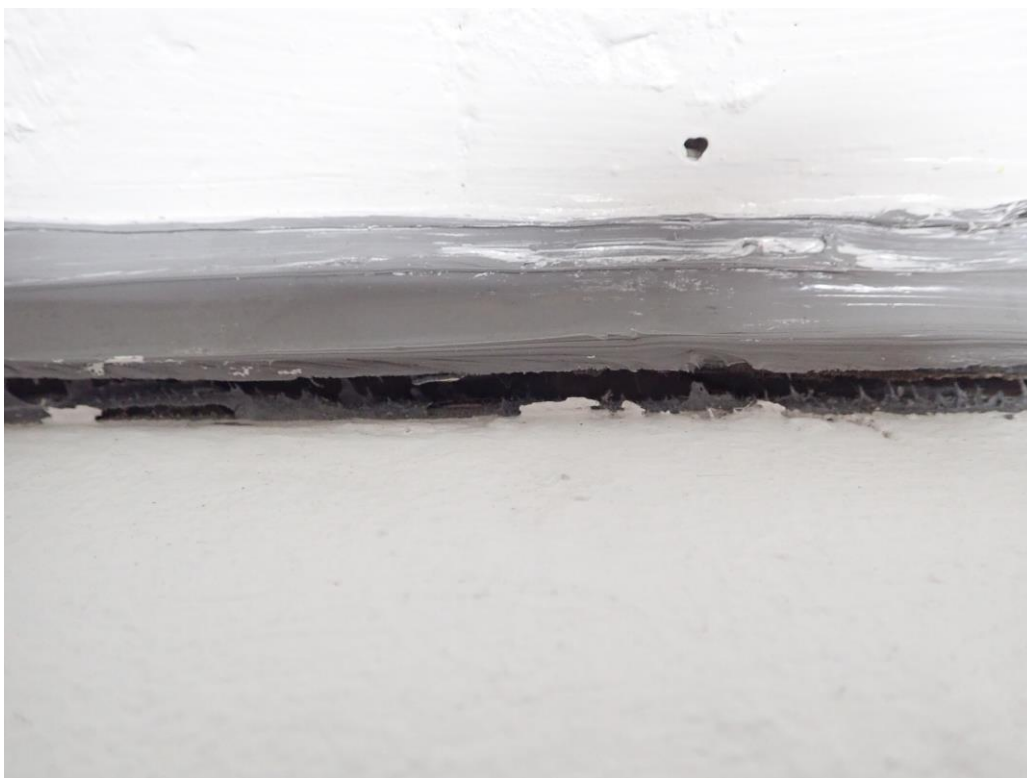
Kuva 12. Rakenteesta irronnut liikuntasauva.
