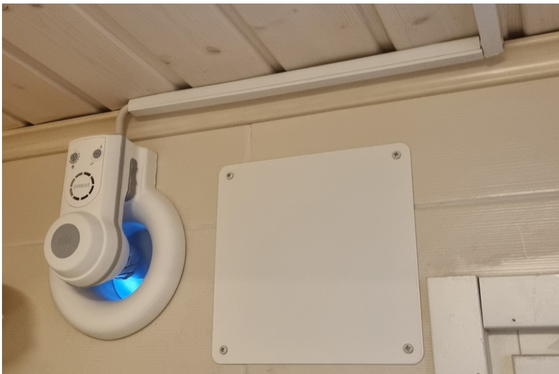
KUVA 19. PAX tilakohtainen poistoilmapuhallin (2022)
