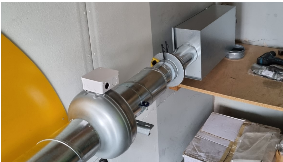
KUVA 8. Tuulettuvaan väliseinärakenteeseen asennettu kanavapuhallin kokonaisuus (2021)
