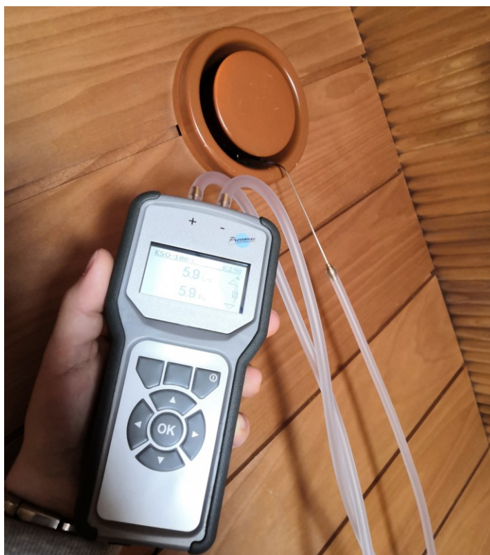
KUVA 15. PHM-V1 Venttiilinsäätömittari ja KSO-100 poistoilmaventtiili (2020)
