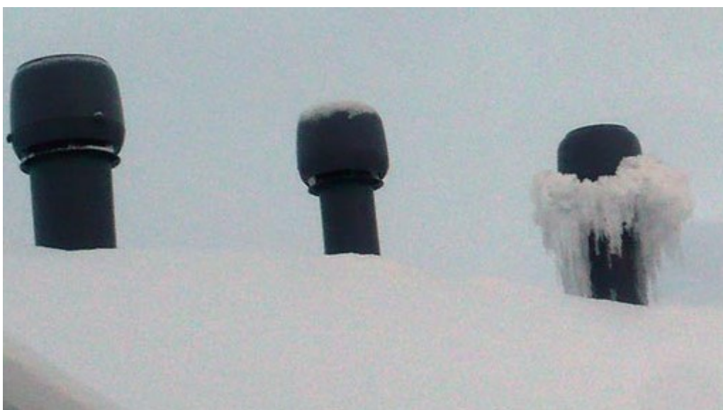
KUVA 16. Jäätynyt poistoilmaputki (Lämpöpumput 2018)
