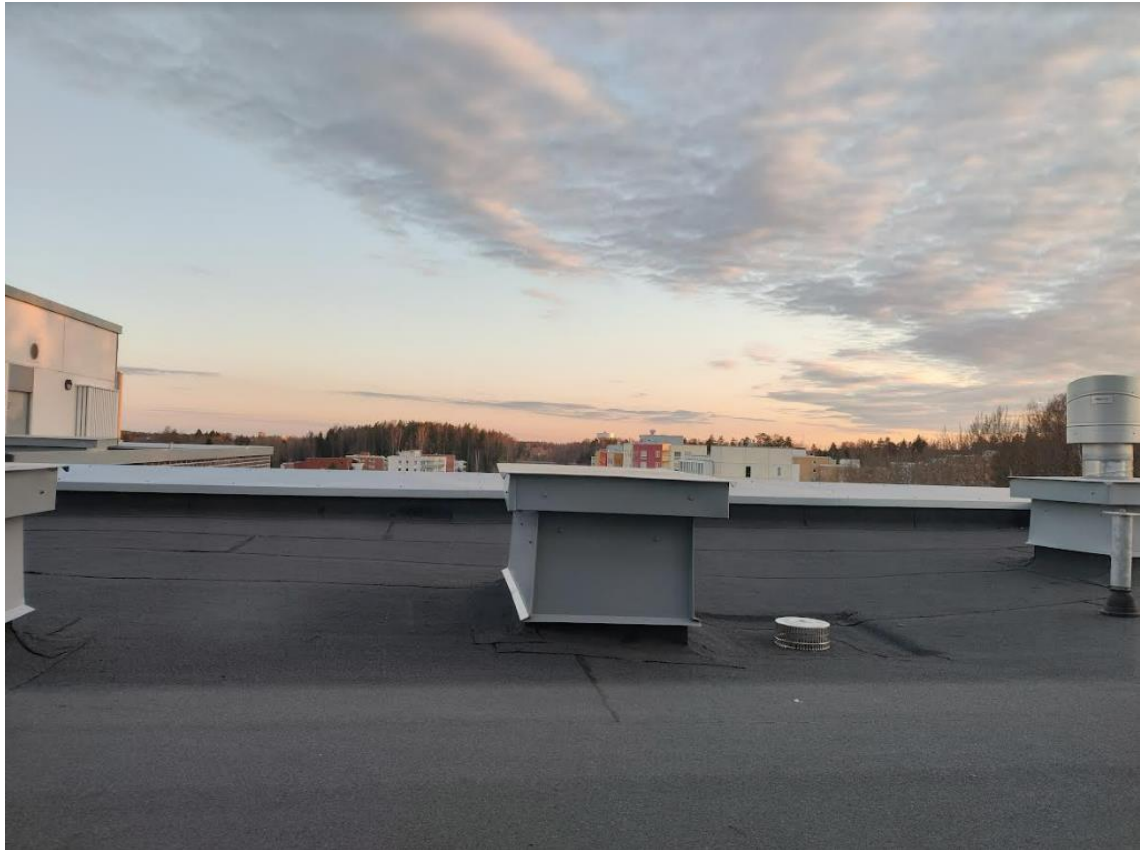
Kuva 5. Tasakaton sisäinen viemäröinti (Kuva: Tuukka Gröhn)
