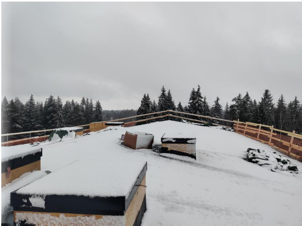
Kuva 14. Vesikaton työalue suojattu kuorielementtikaiteella ja tavaroiden putoaminen estetty verkolla. (Kuva: Tuukka Gröhn 2022)
