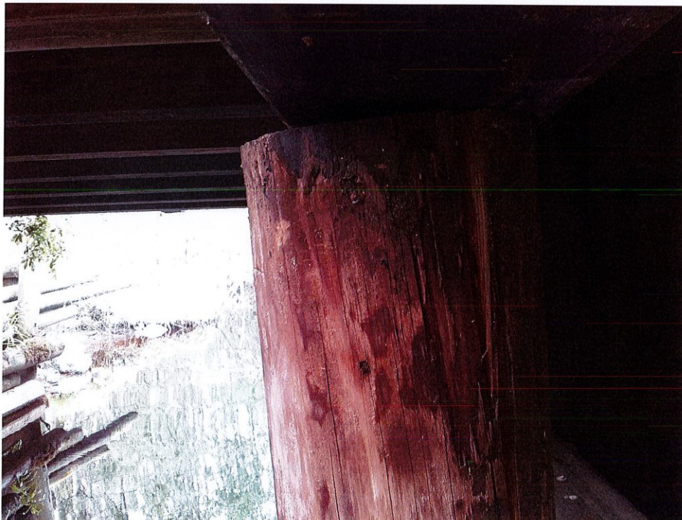
Kuva 10. Sillan tukipaalun halkeamavaurio.
