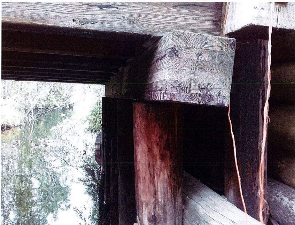
Kuva 12. Sillan niskapalkki on siirtynyt paikaltaan.
