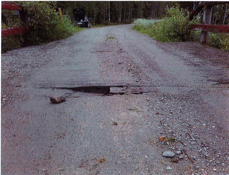
Kuva 8. Sillan puinen kansi ja vauriot näkyvissä.
