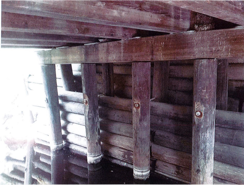
Kuva 11. Sillan tukipaalut ovat kallistuneet uomaan päin ja painuneet alaspäin.
