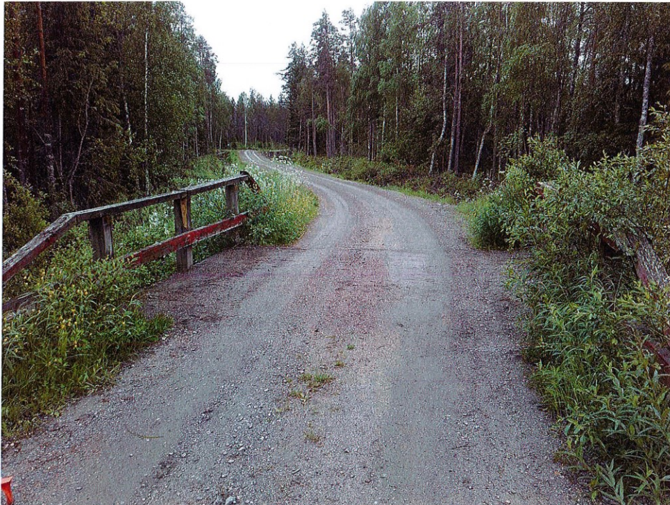
Kuva 7. Sillan kaiteet, pengerkaiteet puuttuvat kokonaan.
