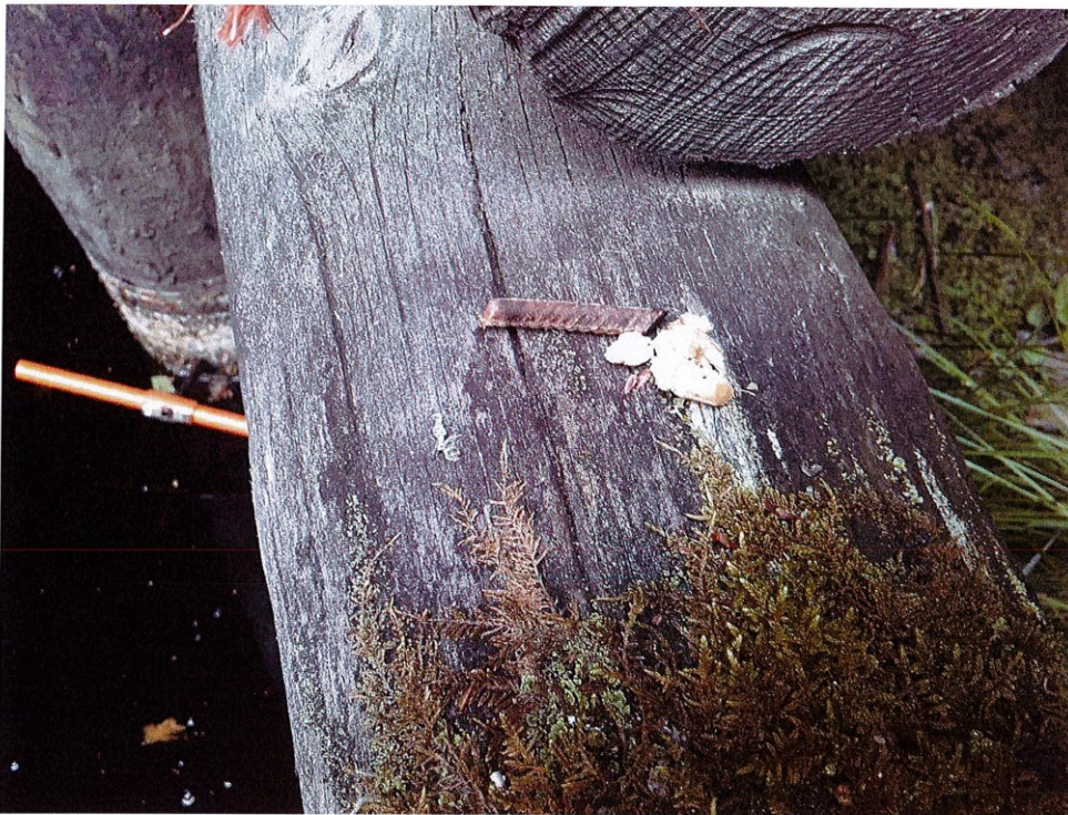
Kuva 9. Sillan tukipaalun kairaus ja kairaustulos näkyvissä, tumma osa on lahoa.
