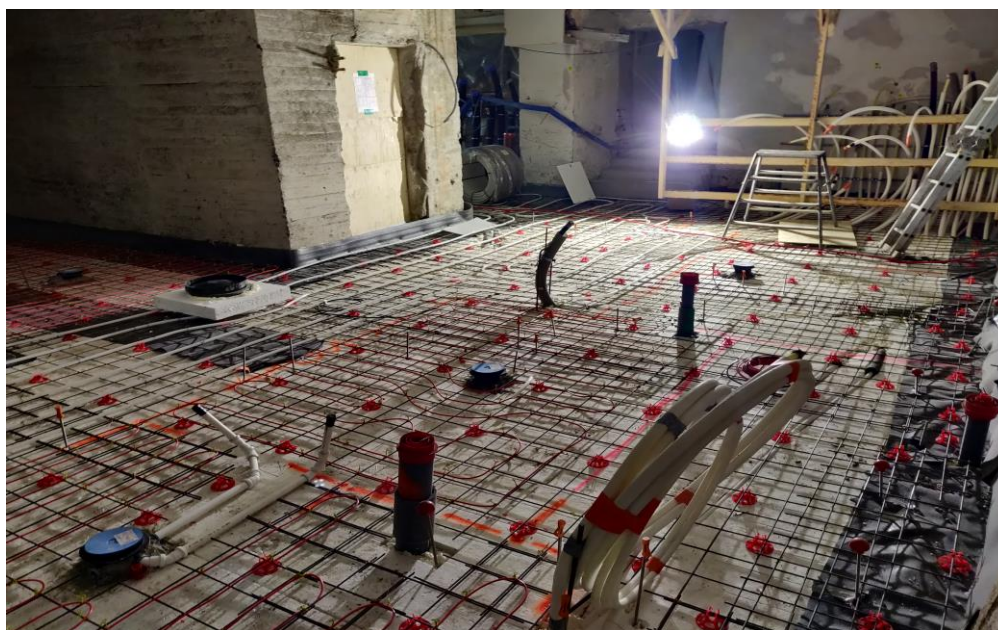
KUVA 19. Kellarikerroksen lattivaluun jäävää talotekniikkaa.
