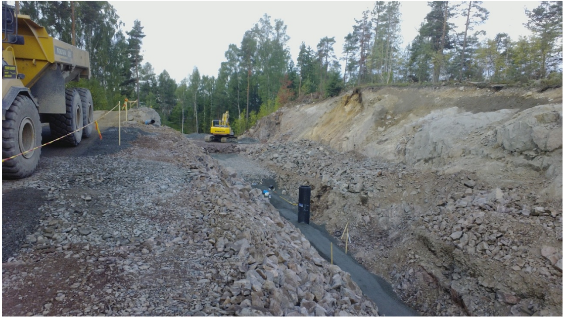
Kuva 37 Bassenkyläntien rakennekerrosten tekoa koneohjauksella. Koneen paikannustiedoista voi seurata työn etenemistä. (Kuva: Mattijaakko Määttänen)
