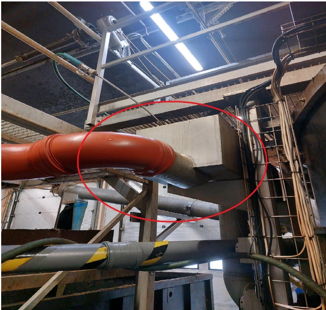
Kuva 7: Flotaation ylivuotoallas. Putki säiliölle nro 1 asennetaan punaisella ympyröityyn kohtaan vaihtamalla putken kappale haarayhteeseen.
