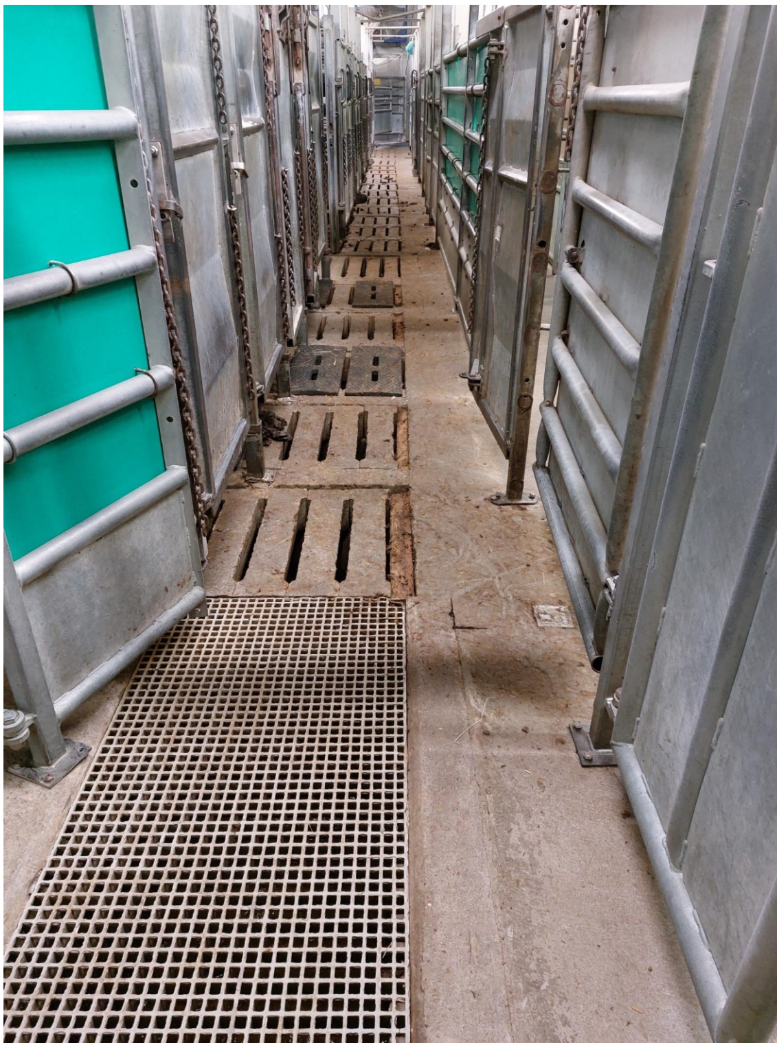
Kuva 12: Putki sijaitsee navetan pääkäytävän ritilöiden alla, kuilun pohjalla. Putken sijoitus syväälle kuiluun varmistaa sen, ettei huuhteluvesi pääse roiskumaan lantakanaalista navetan lattialle tai käytävillä liikkuvien eläinten tai ihmisten jalkoihin.
