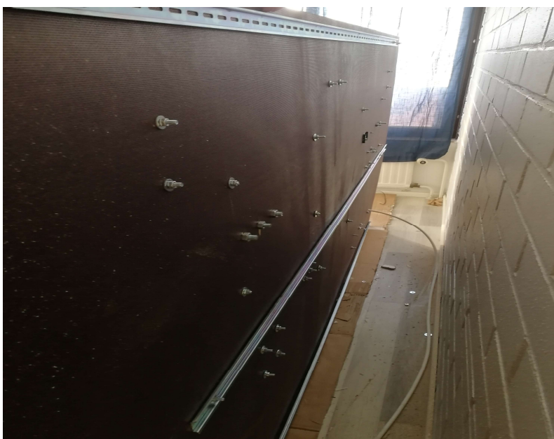
Kuva 12. DIN-kiskot levyn takana.
