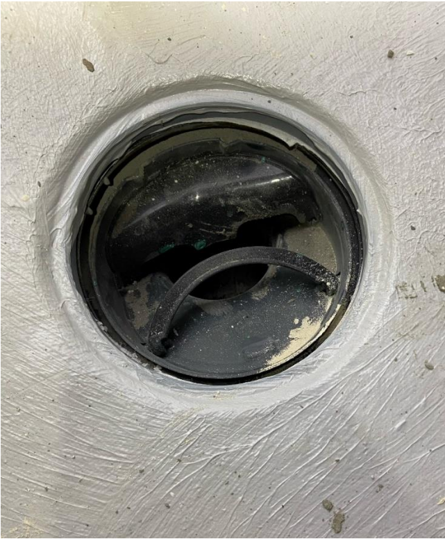
Kuvio 4 Lattiakaivo tiivistetty vahvikerenkaalla ja vahvikekankaalla.
