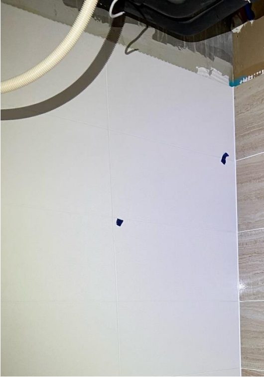
Kuvio 6 Työnjohtaja merkannut laatoitukseen korjattavia hammastuksia teipillä.
