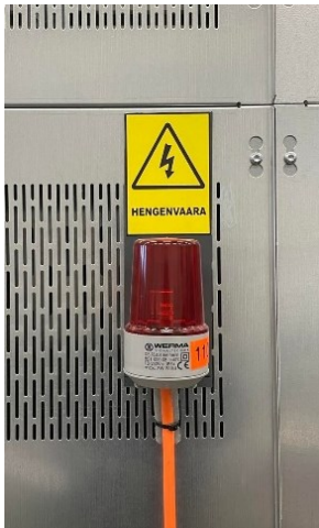
Kuva 13. Kaapelilla varustettu merkkivalo.
