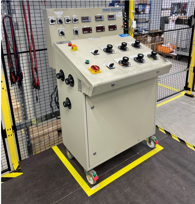
Kuva 3. Kytkinkotelo pyörillä varustetun alustan päällä.
