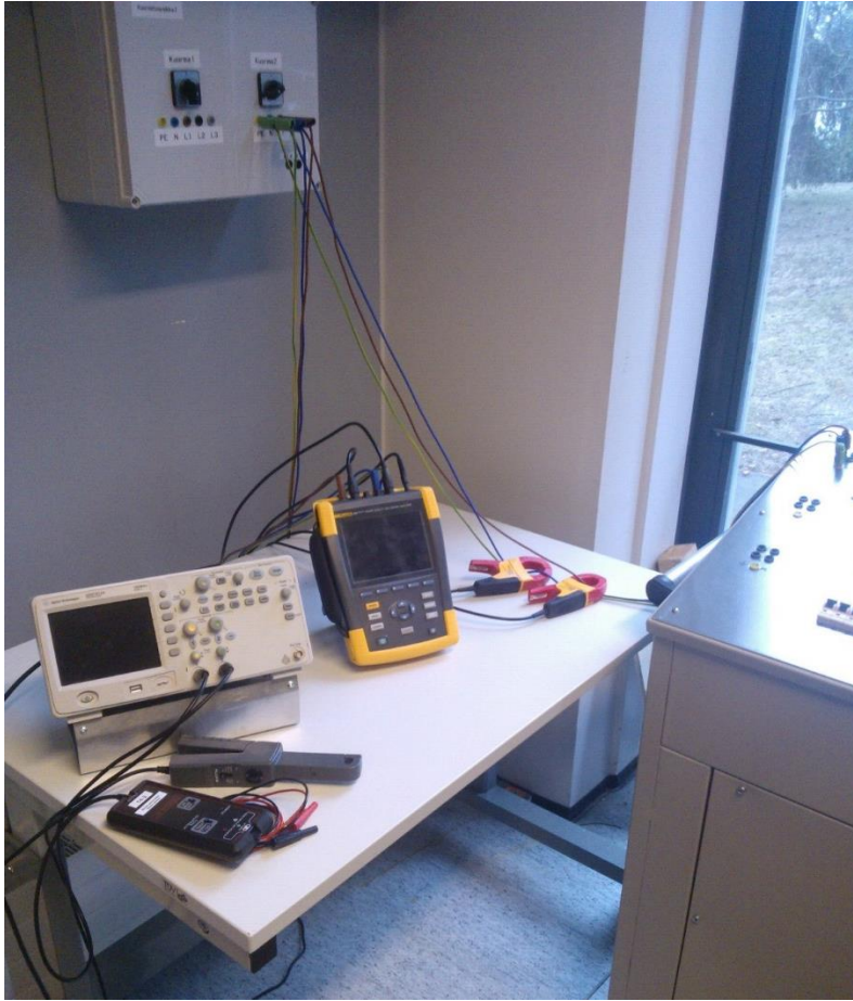
KUVA 18. Työssä käytetty mittauskytkentä
