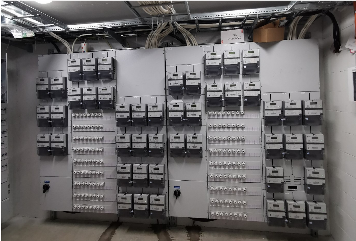
Kuva 4: Kerrostalokiinteistöissä jokaisen asunnon sähkönkäyttöä mitataan yleensä omalla verkkoyhtiön energiamittarilla. Mittausjärjestelyt tulee huomioida asuntojen yhdistämistä suunnitellessa.
