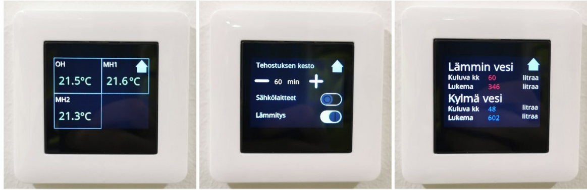
Kuva 5: Asunnon ohjauspaneelista on mahdollista ohjata ja monitoroida esimerkiksi tilojen lämmitystä, ilmanvaihdon tehostusta ja veden kulutusta. Asuntojen yhdistämiseen tai erottamiseen varautuessa tulee miettiä mahdollisuuksia näiden ohjauksien integrointiin. Alan toimijoiden haastattelujen perusteella näin ei ainakaan toistaiseksi toimita.
