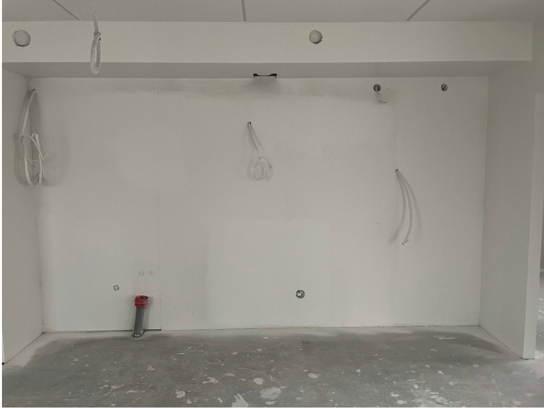
Kuva 2: Esimerkki keittiön vaatimasta talotekniikasta Bonavan kerrostalotyömaalta. Mikäli asunnot yhdistetään, voidaan toisen keittiön tekniikat jättää varauksiksi päättämällä ne turvallisesti rakenteisiin. Kuva: Bonava
