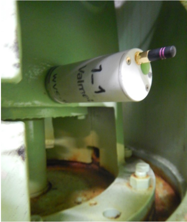
KUVA 7. Pumpun alemmalle laakerille asennettu WVS-100 värähtelyanturi
