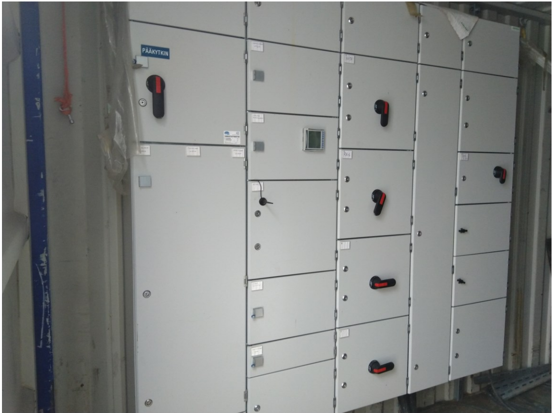
Kuva 11. Pihakeskuksessa sijaitseva kennosto, jossa on nykyinen PK sekä RK1 ja RK2.
