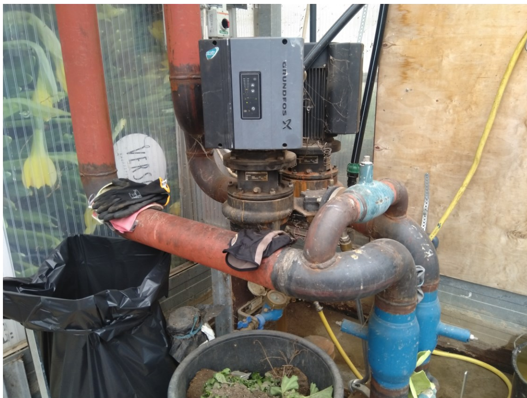
Kuva 14. Grundfos-merkkinen virtausmittari, joka mittaa Gasum Oy:n biokaasulaitokselta tulevan ja palaavan lämmitysveden virtaamaa ja lämpöä.
