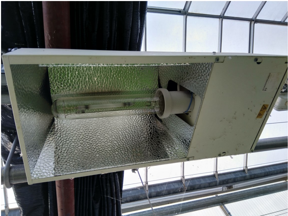
Kuva 22. Mittausalueen valaisimet olivat kaikki 400 watin Hel-light-suurpainenatriumvalaisimia, joissa oli käytössä eri valmistajien lamppuja.
