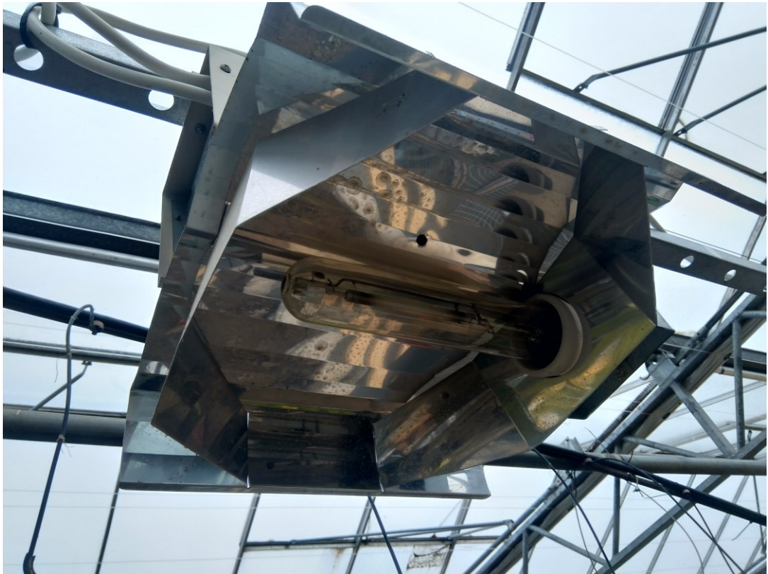
Kuva 16. Osaston D tuntemattoman valmistajan 400 W:n suurpainenatrium-valaisimet, päädyn tarrassa lukee malli: 265 NA 400L.
