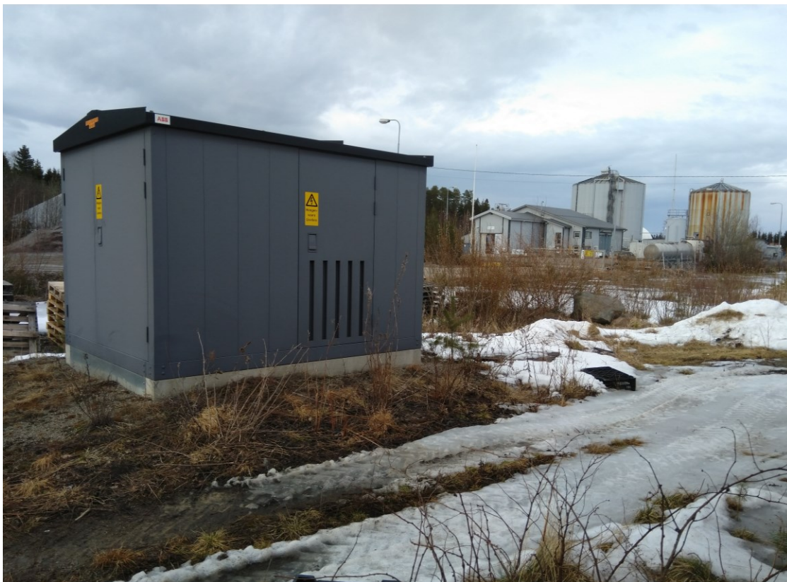
Kuva 2. Ulkona noin 15 metrin päässä kasvihuonekiinteistöstä sijaitseva ABB Oy:n 20 kV:n muuntajayksikkö, oikealla Gasum Oy:n rakennuksia.
