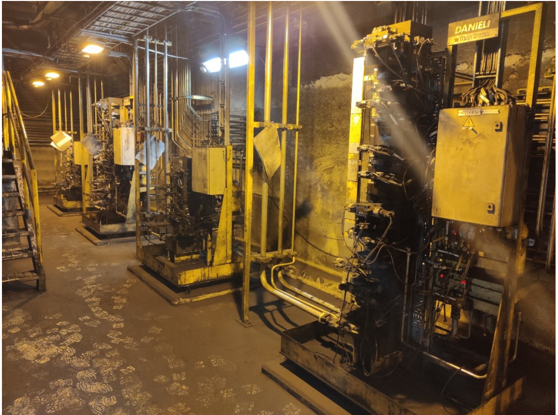
kuva 16. Kellarikerroksen hydraulikka ständit.
