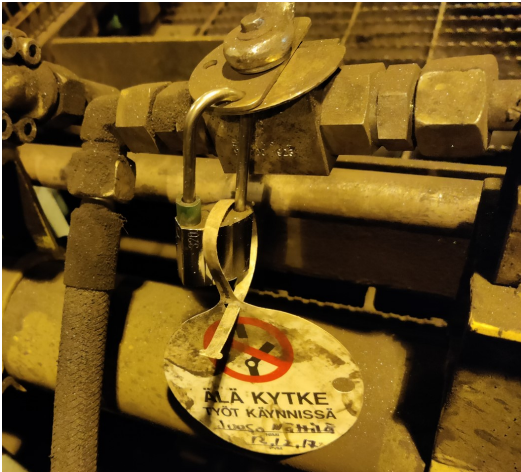
Kuva 9. Lukittu hydraulinen venttiili.
