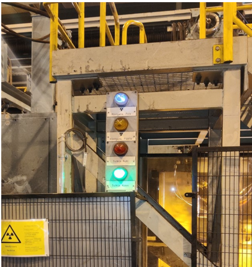
Kuva 10. Hitsauslaitteen tulopuolen varoitusvalot.
