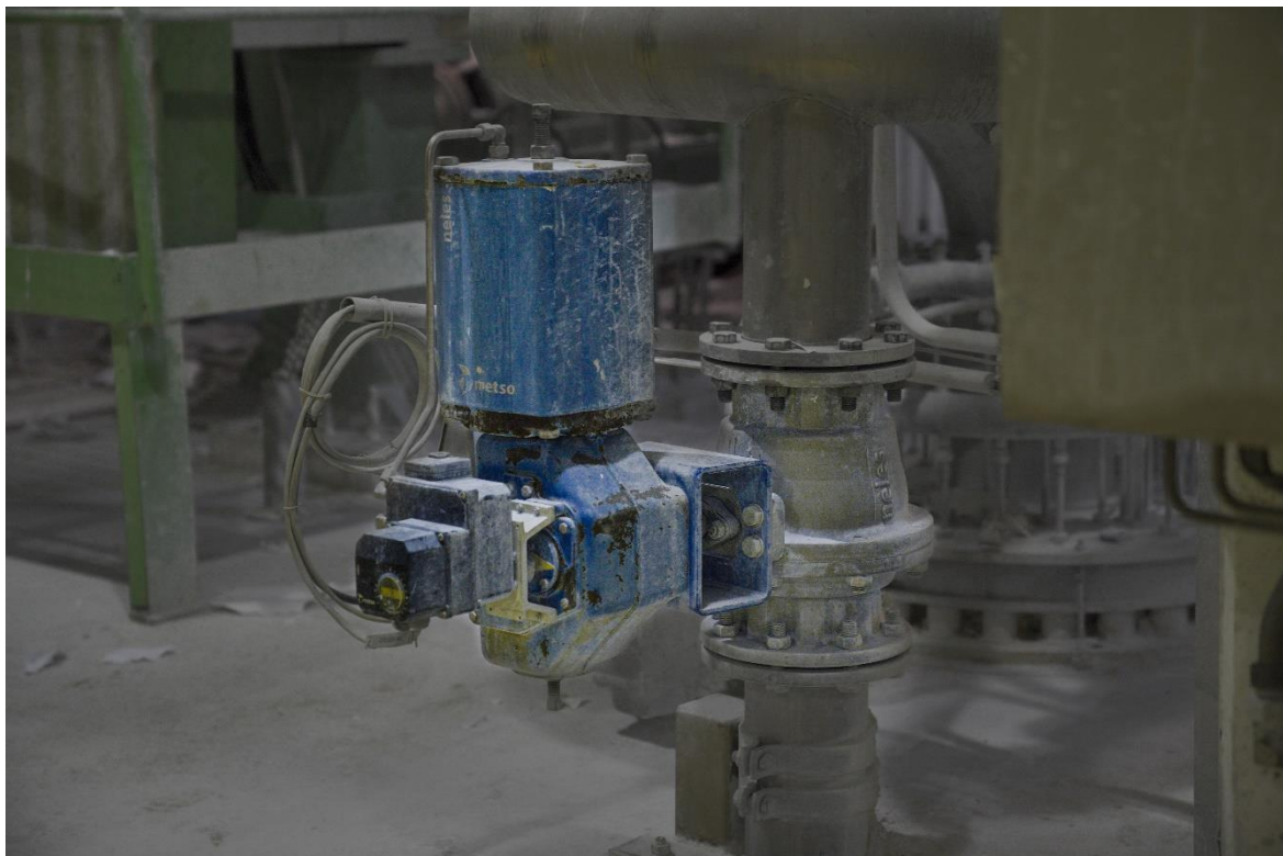
Kuva 5. Automaattiventtiili (Kuva: Santeri Leino)
