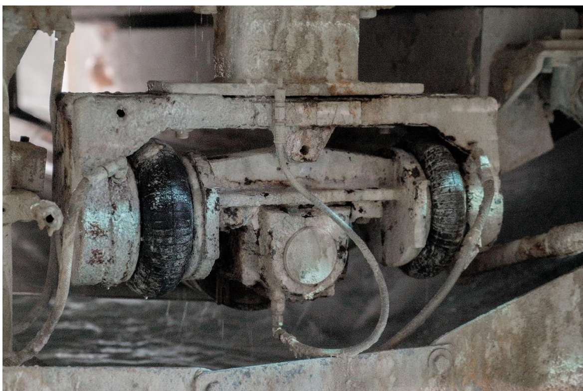
Kuva 9. Pesupuristimen ohjaustelan paljesylinterit (Kuva: Santeri Leino)
