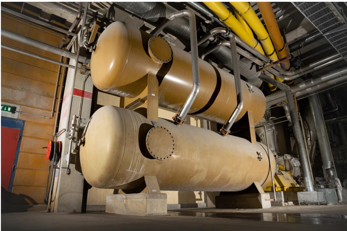
Kuva 8. Paineilmakompressori 2 paineilmasäiliöt (Kuva: Santeri Leino)
