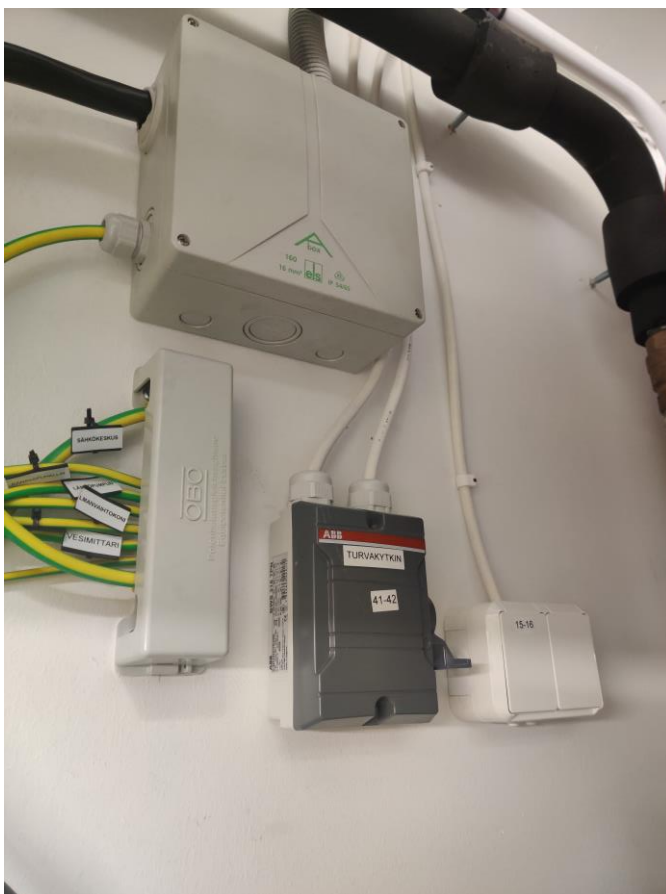
KUVA 5. Tekniikkamoduulin liitinkotelo ja maadoituskisko
