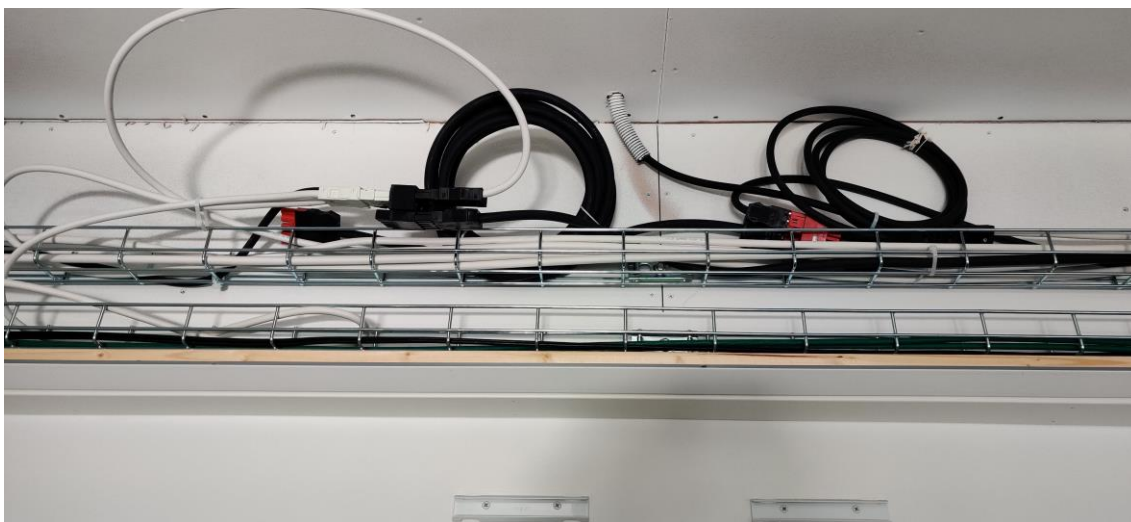
KUVA 3. Päätyseinän lankahylly ja WINSTA-haaroitin
