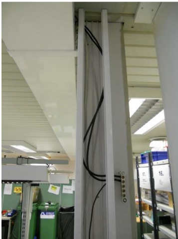
36. Muovisissa johtokanavissa riittää asennuskapasiteettia
