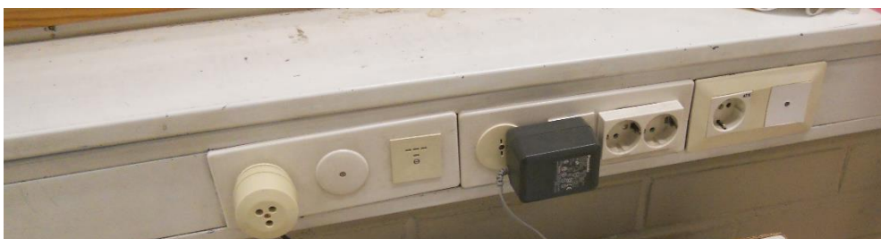
KUVA 2. Teräksinen johtokanava, josta löytyy sähkö- ja teleliitäntäpisteitä.
