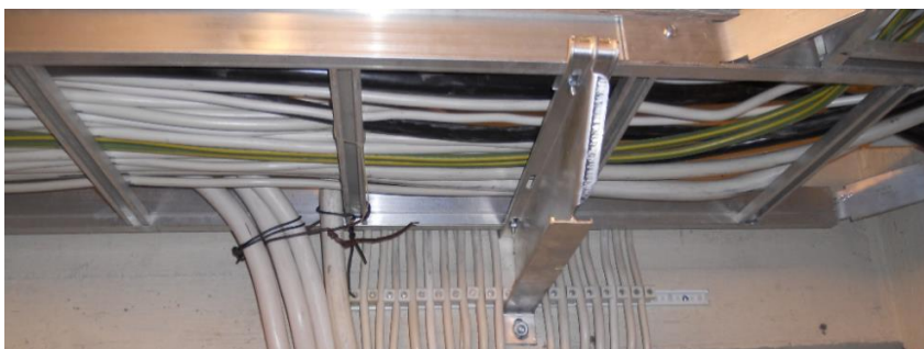
KUVA 34. Pääkeskustilan tikashyllyjen asennuskapasiteetti alkaa käydä vähiin
