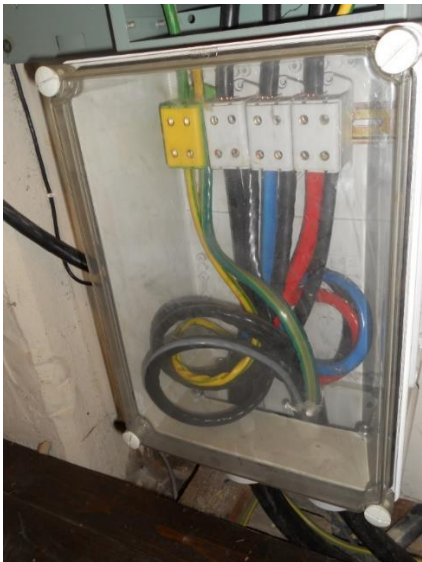
KUVA 48. Muuntoliitos- ja syöttökaapeliin kytkentäkotelo
