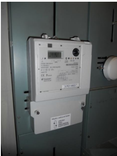
KUVA 49. Kiinteistön 2-tariffi-kWh-mittari on etäluettava
