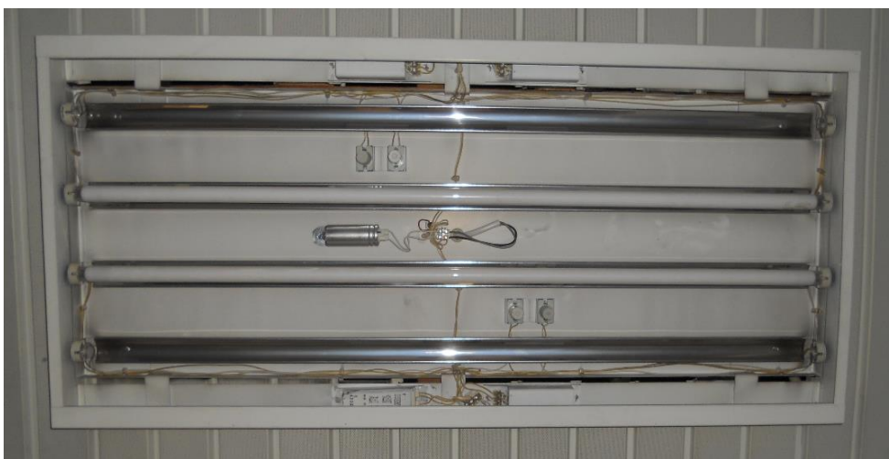
KUVA 73. Valaisimissa on neljä loisteputkea, liitälaitetta ja sytytintä
