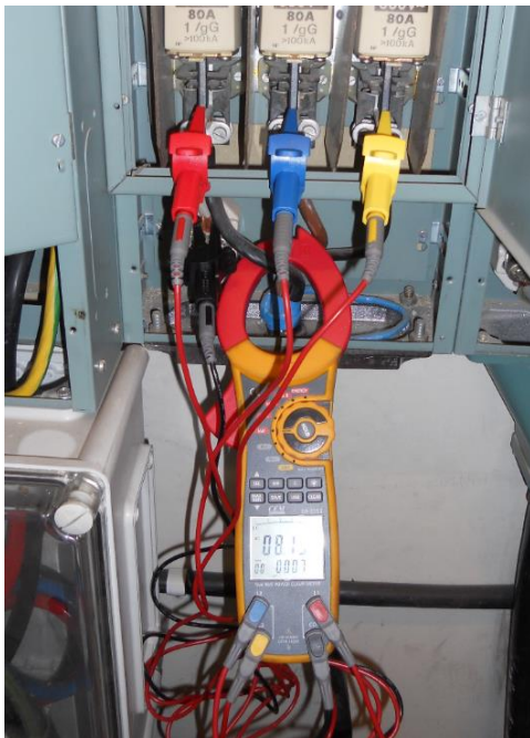
KUVA 61. Ryhmäkeskuksen RK03 vaihetehojen mittaus pääkeskukselta
