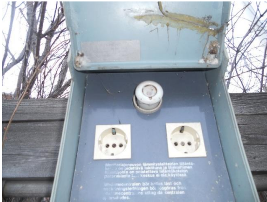
KUVA 71. Autolämmityspistorasiakotelon sisältä löytyi ampieispesän jäänteitä
