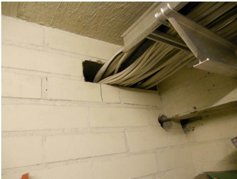
KUVA 39. Pääkeskustilan läpivienti on täynnä
