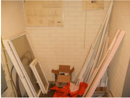
KUVA 41. Pääkeskustilaan on kertynyt ylimääräistä tavaraa
