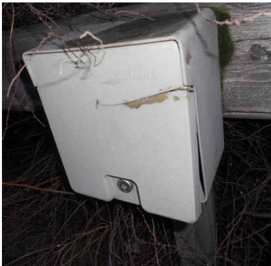
KUVA 6. Autolämmityspistorasia, jonka kotelon kansi on vioittunut.
