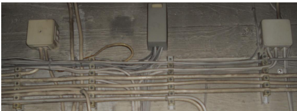
KUVA 32. Seinäkiinnikkeillä tehtyjä pinta-asennuksia
