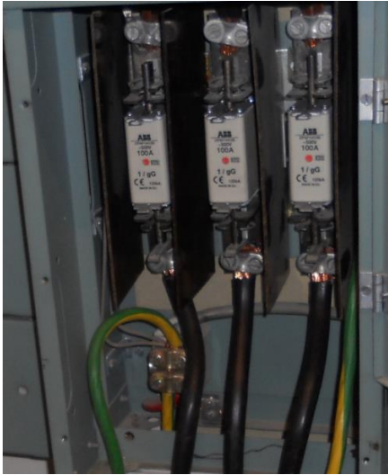
KUVA 47. Kiinteistön pääsulakkeet 3x100 A
