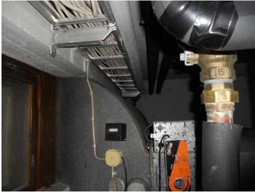
KUVA 35. IV-konehuoneessa kulkeva tikashylly
