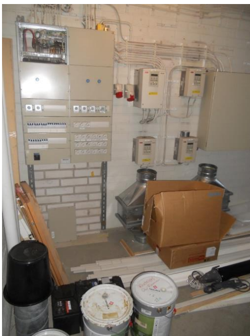
KUVA 43. IV-konehuoneen ryhmäkeskuksen eteen on kertynyt roinaa
