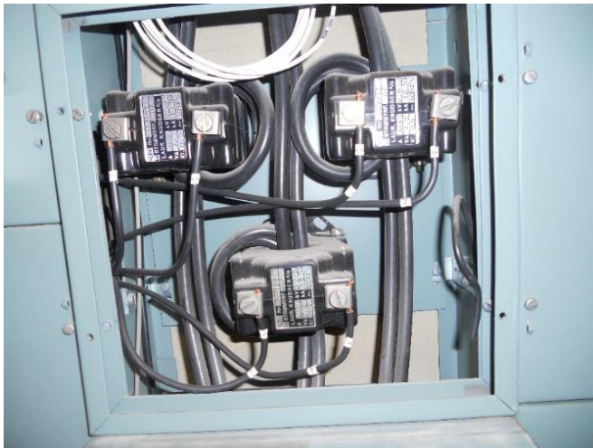
KUVA 50. Virtamuuntajien (3 kpl) päälle on päässyt kertymään pölyä
