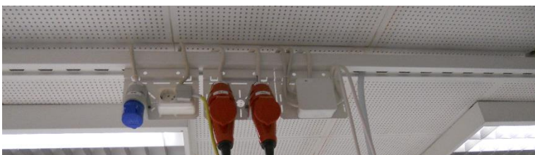
KUVA 37. Valaisinripustuskiskoilla kulkee pintaliitoskoneiden syöttökaapeleita
