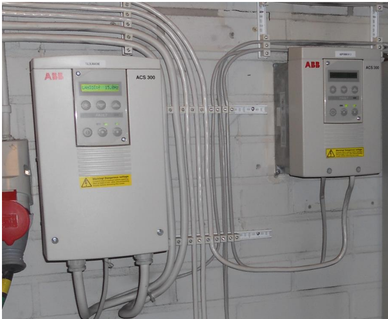
KUVA 4. Taajuusmuuttajilla säädetään usein ilmastointikoneen puhaltimia.
