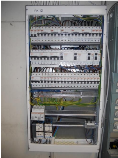
KUVA 56. Ryhmäkeskuksen RK12 sisusta on puhdas ja johdotukset ovat siistejä
