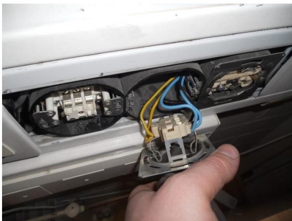
KUVA 69. Pistorasioiden liitokset on tehty hyvin
