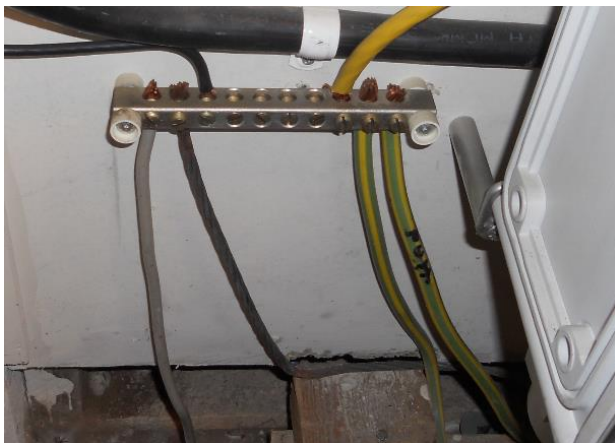
Kuva 75. Maadoituselektrodi on kiinnitettyä pääpotentiaalintasauskiskoon
