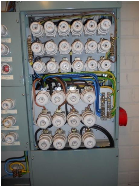
KUVA 52. Ryhmäkeskuksen RK03 johdotukset on tehty siististi
