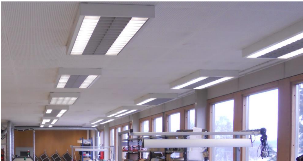
KUVA 74. Lähes jokaisesta valaisimesta puuttuu loisteputkia tai ne ovat rikkiäisiä
