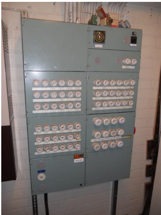
KUVA 51. Ryhmäkeskus RK03 pääkeskustilassa
