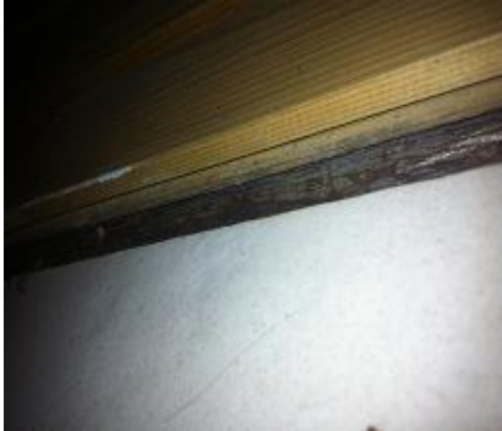
Ei tuuletusrakoa paneelin takana.
