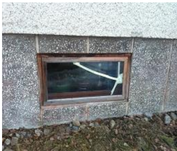
Halkeama kellarin ikkunassa.
