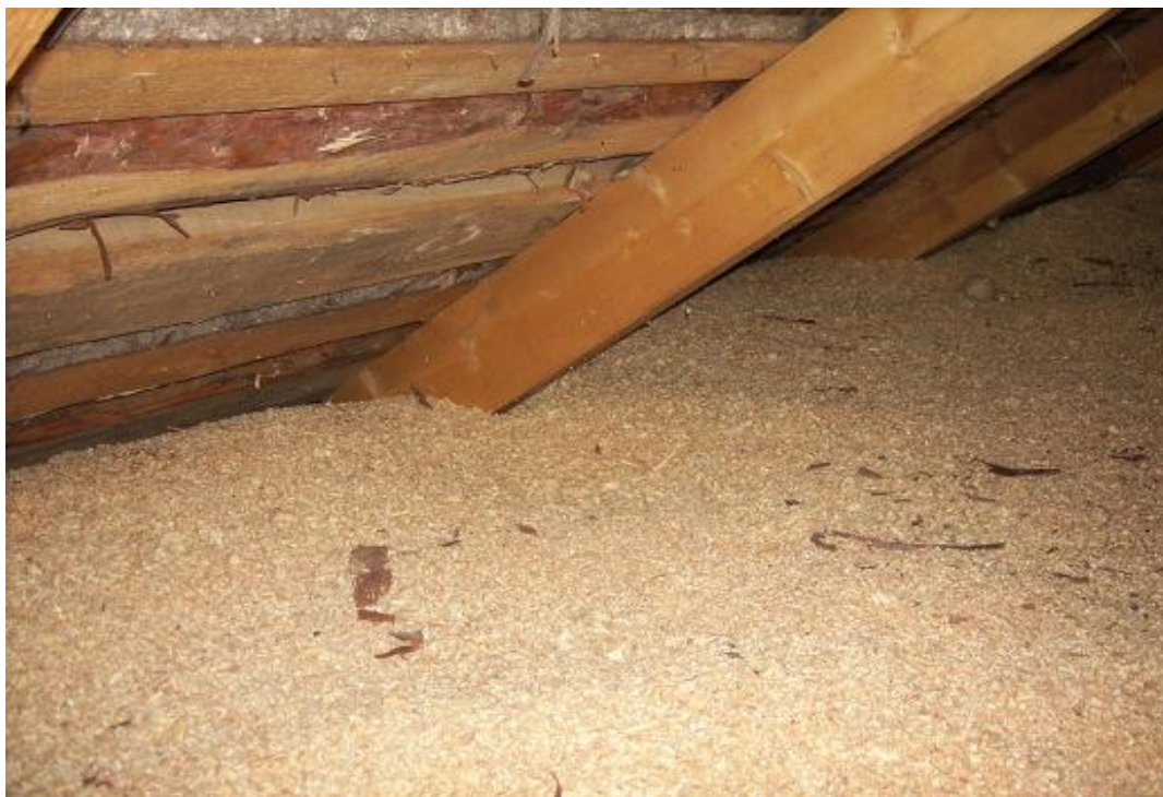
Eriste on vesikatteessa kiinni.
