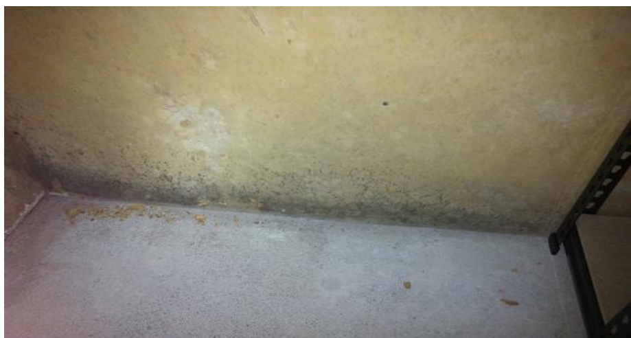
Sisäpuolelta eristetyn maanvastaisen seinän alareunassa havaittiin merkkejä kosteusvauriosta.
