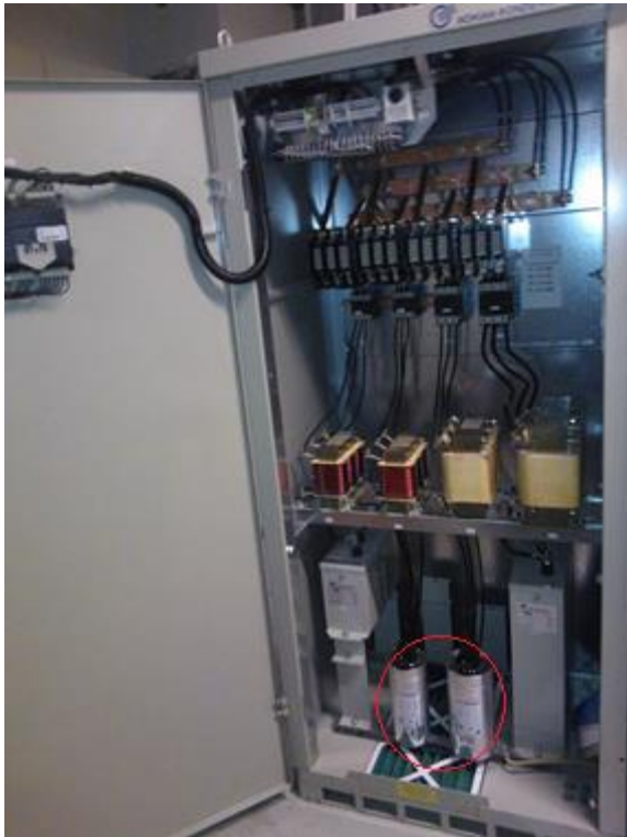
Kuva 5. Kompensointilaite, johon on uusittu kaksi porrasta. (Kuva: Vitkala 2014)
