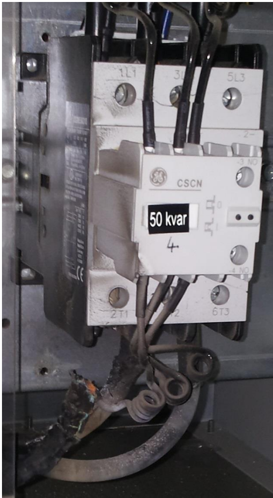
KUVA 2. Kontaktori, jonka yhden vaiheen johto on sulanut. (Kuva: Arto Vitkala 2014, muokattu)
