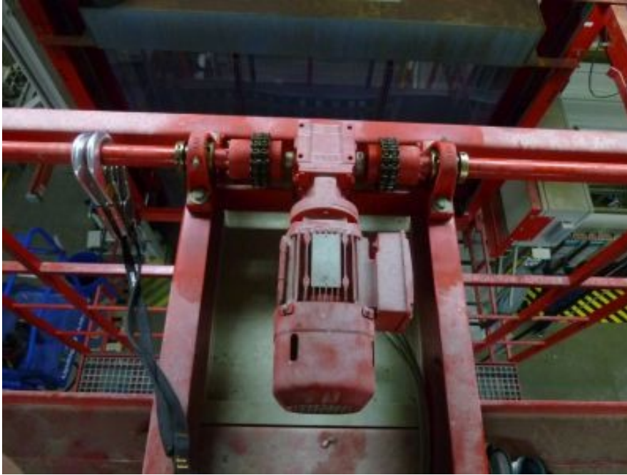
Kuva 18. Kuljetusvaunun päällä sijaitseva ajomoottori
