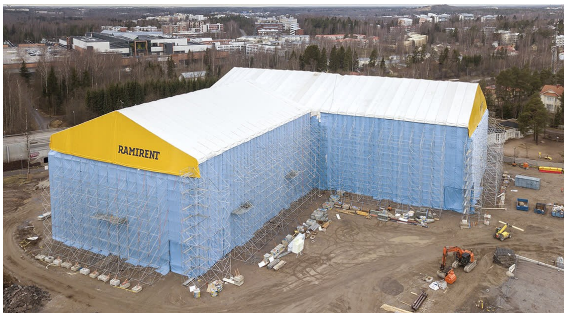
Kuva 1. Suuri, koko rakennuksen suojaava sääsuoja (Ramirent n.d)
