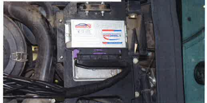
Kuvassa kaasujärjestelmän ECU sijoitettuna moottoritilaan.
