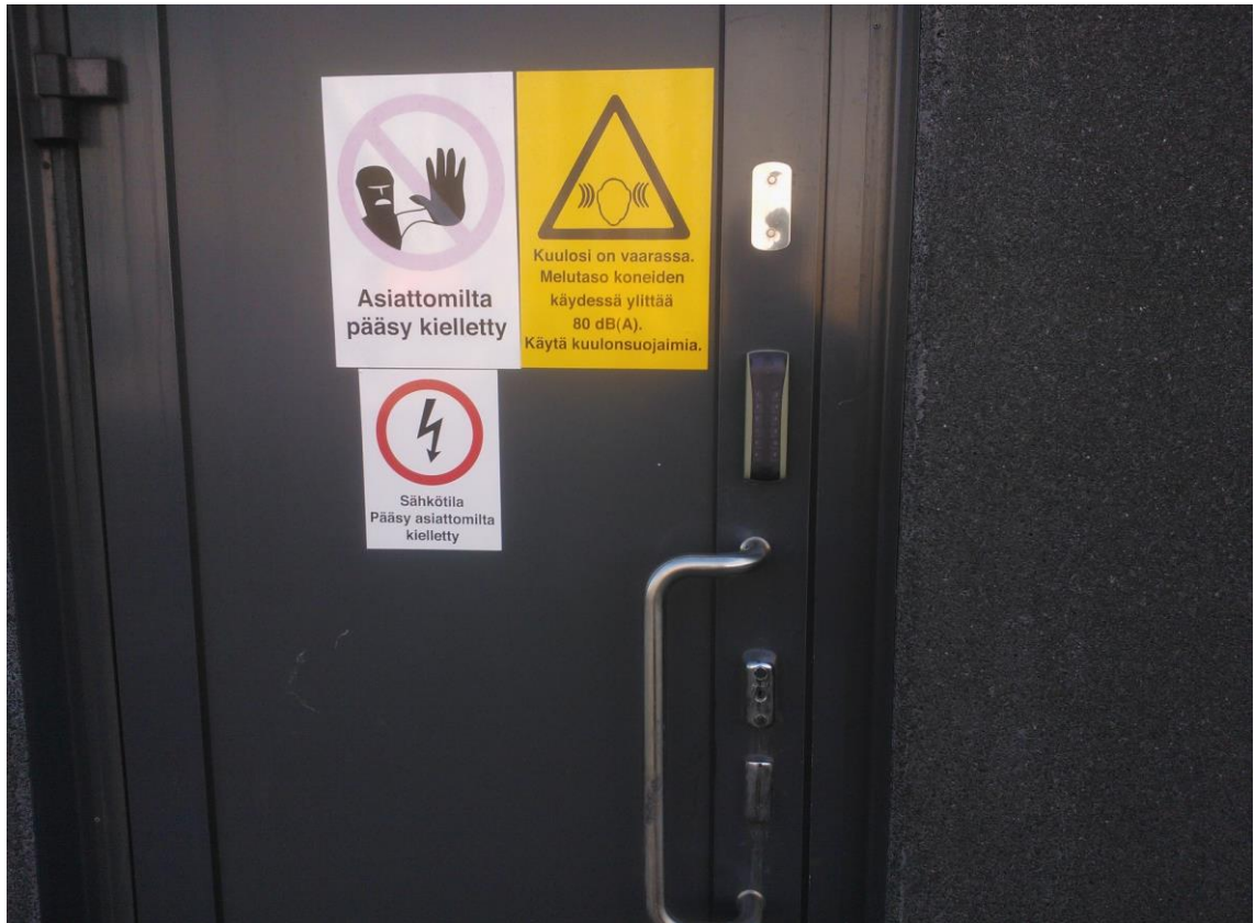
Kuva 1. Sähkölaittekorjaamon ovi varoituskilpineen
