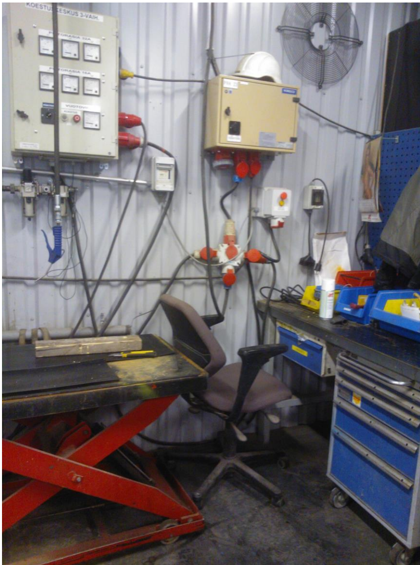
Kuva 4. Tuusulan keskuskorjaamon eristämätön seinä
