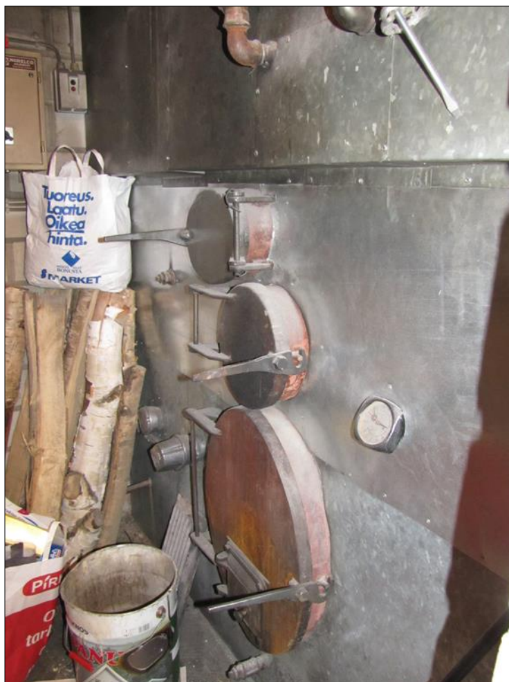
Kuva 12. Nykyinen kattila sähkövastuksineen ja varaaja. (Kuva: Minna Koivu-Asikainen.)
