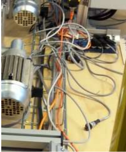
Kuvio 14. Laitteiston kaapelointi
