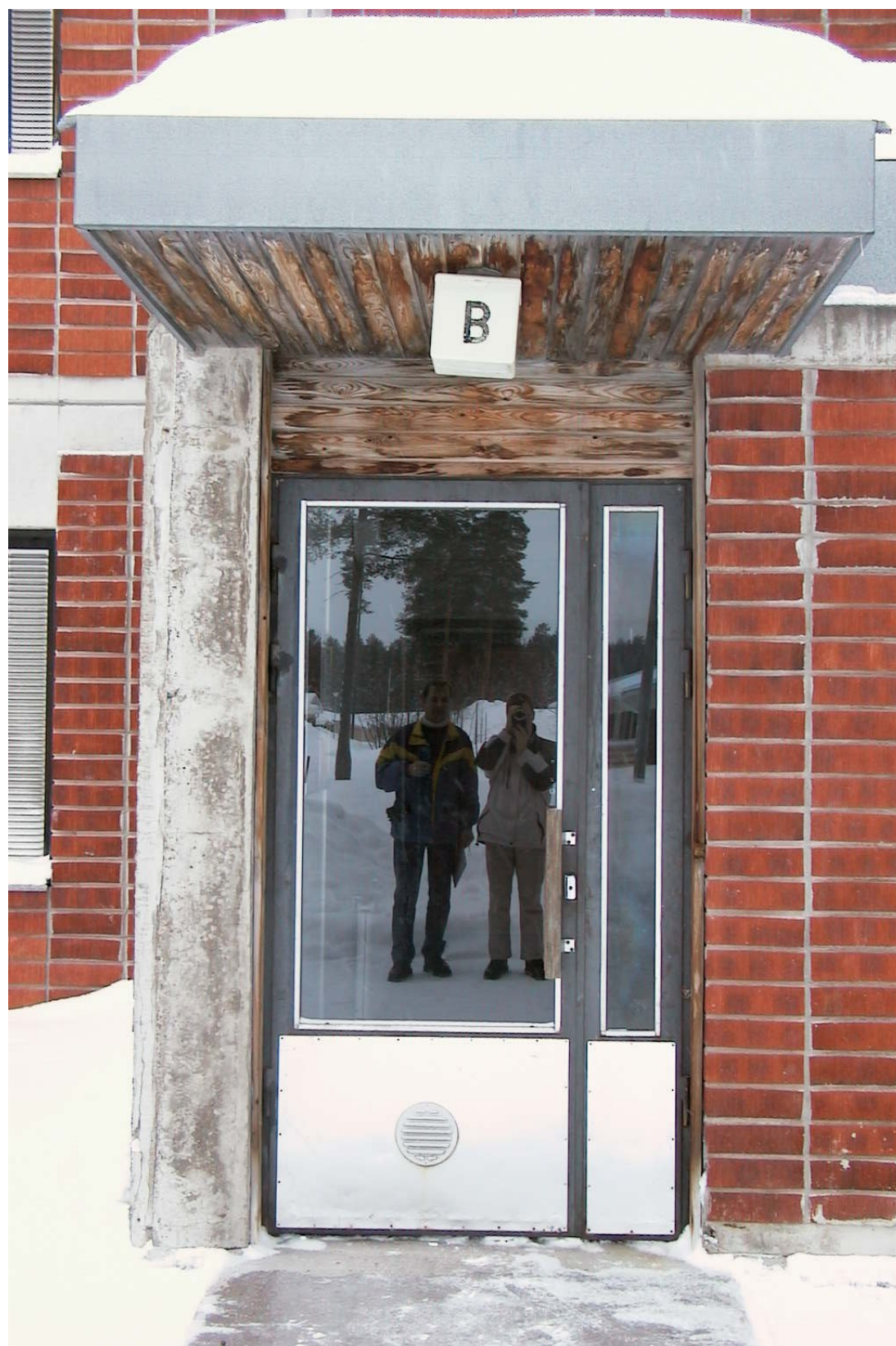
Ulko-ovet olivat huonokuntoisia ja kuuluvat KL 3
