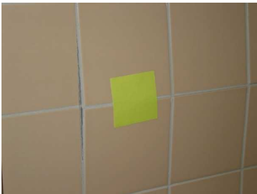
Kuva 13. Betonin kuivumiskutistuman aiheuttama laattojen irtoaminen alustastaan. Kuva Tero Niemelä, Skanska Talonrakennus Oy.
