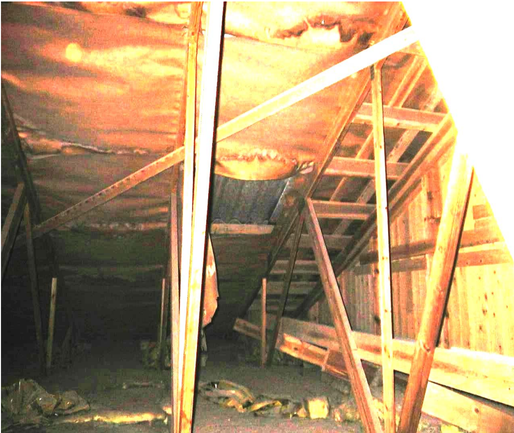
6. Länsipäässä aluskatetta on irronnut kokonaan.
