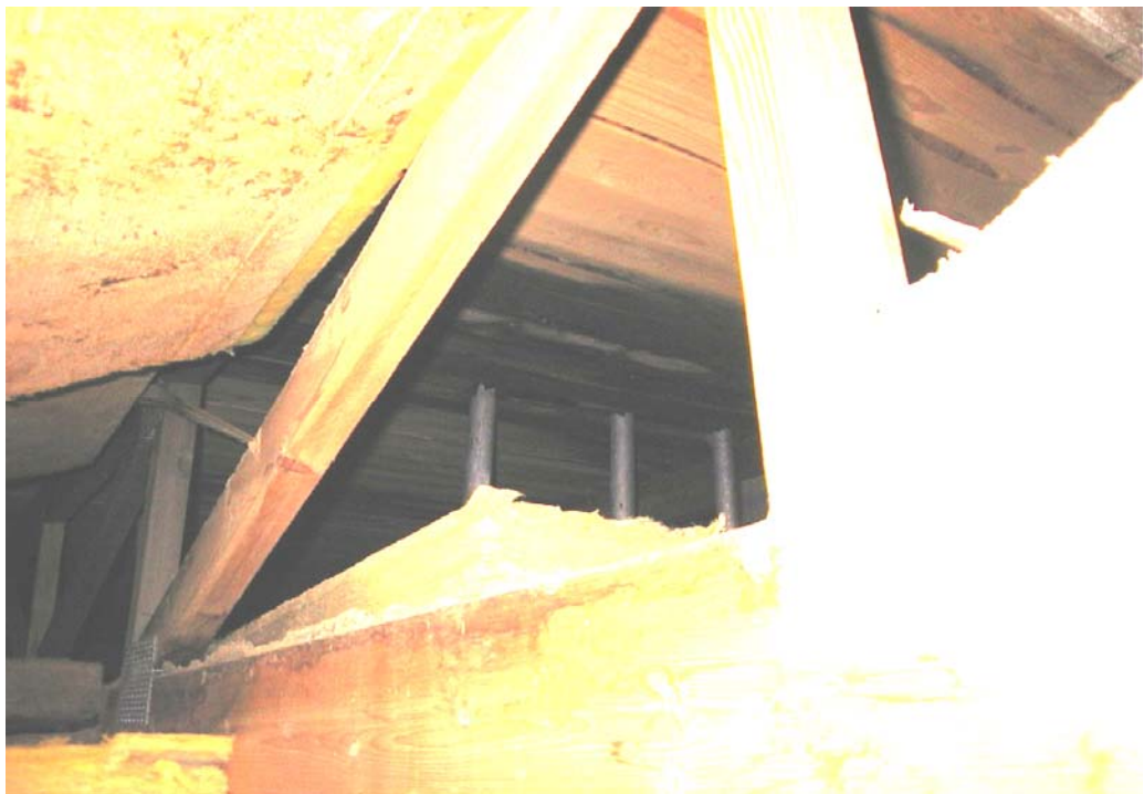
10. Sprinkleri putkien läpiviennit ovat huonot. Putkien välistä puuttuu raakapontti, eli huopa on tyhjän päällä. Tämä kohta mm. vuotaa lumien sulaessa katolta. Kuvat on otettu vanhan räystääselementti pöydän luota. Kahteen isompaan vuotokohtaan lujuuslajittelun purkuhissin luona ja höylän vastaanotossa ei päässyt valokuvaamaan.
