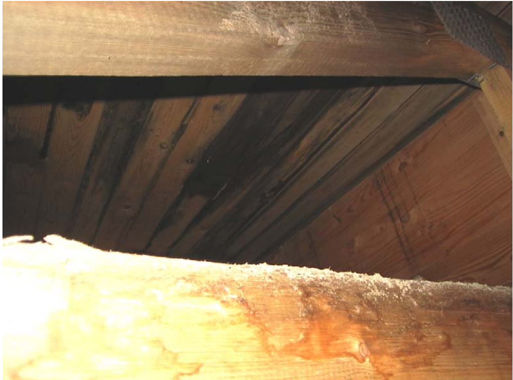
9. Raakapontti jatkettu villinä ja oli tässä kohti sinistynyttä. Myös sekundääri ristikot ovat jonkin verran sinistyneet.
