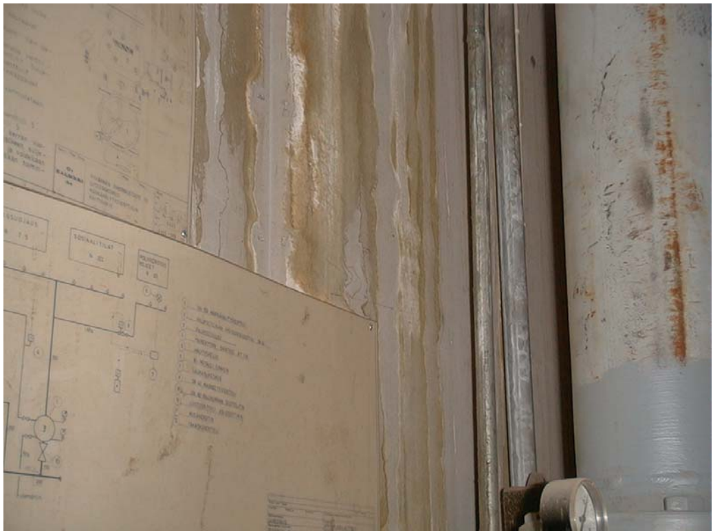
18. Sprinklerikeskuksen seinät ovat katolta valuvan veden kastelemat.
