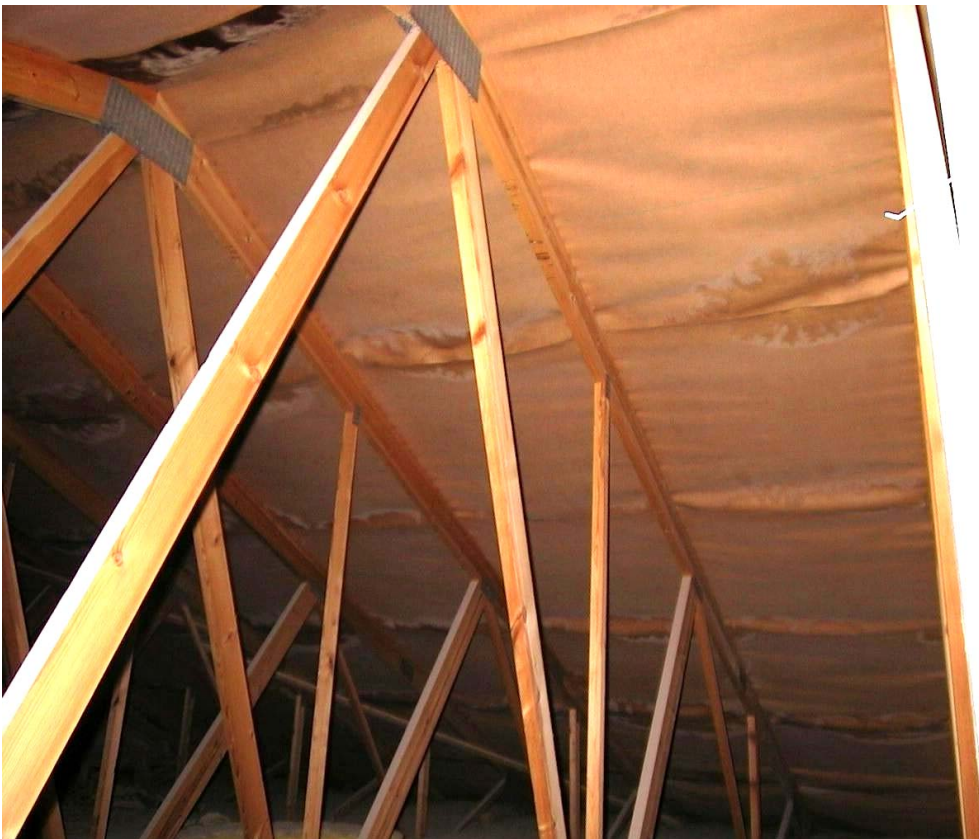
4. Itäsiiven aluskatteessa kauttaaltaan liian vähän limitystä (n.5 cm). Saumakohta alkaa helposti vuotaa jos vesi valuu aluskatetta pitkin.
