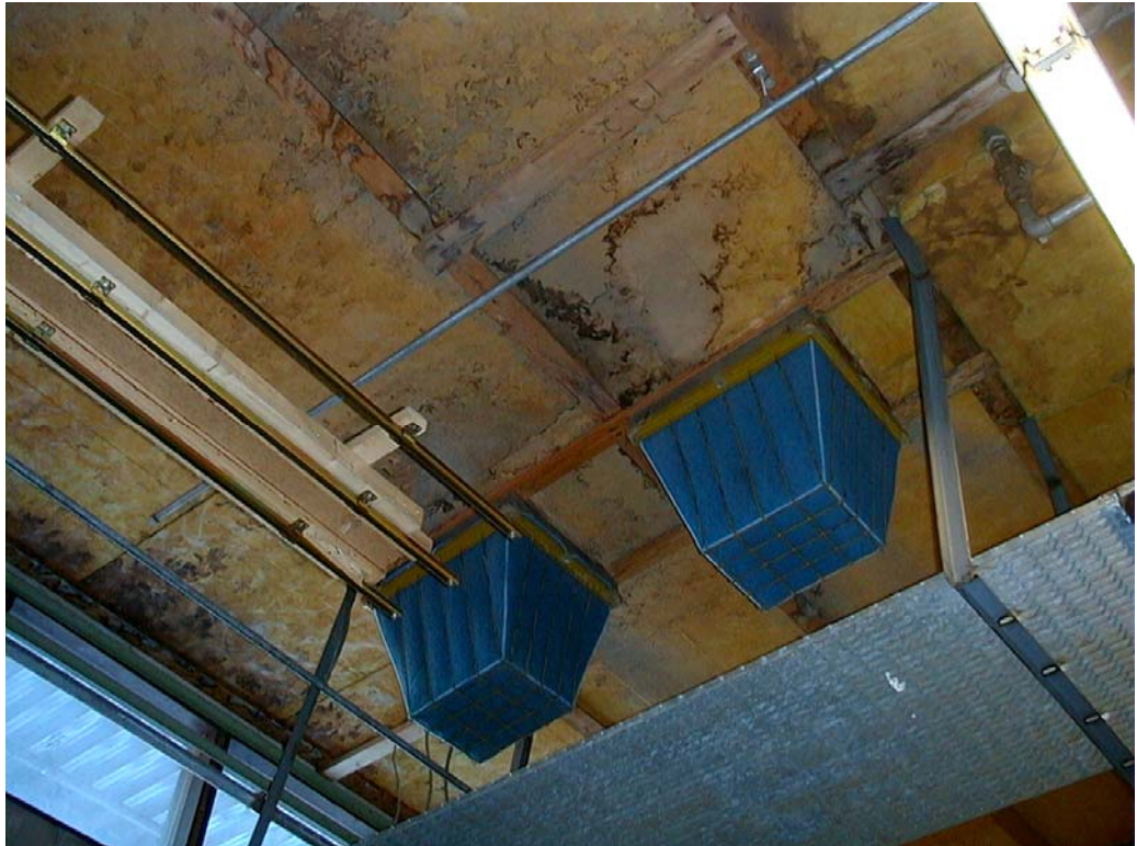
17. Suodatinyksikön itäpäässä on myös ollut vesivuotoa. Kuvasta on nähtävissä myös räystäsvuodon aiheuttamaa villojen tummumista.
