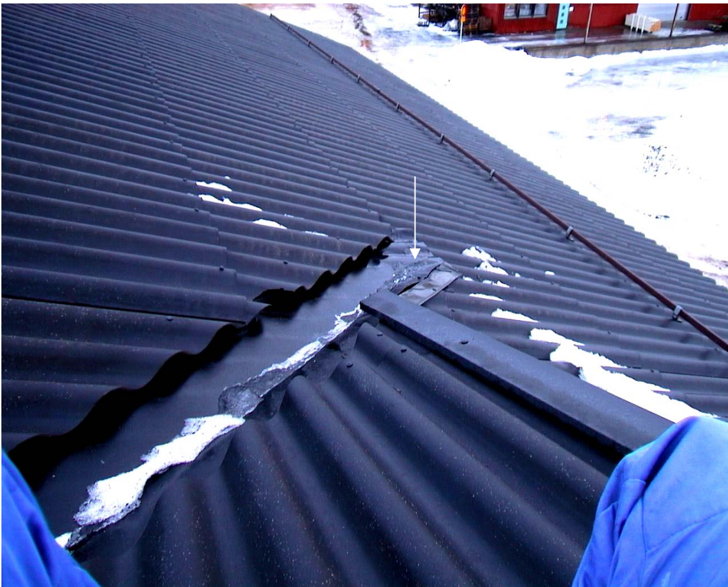
2. Vuotokohta ulkoapäin. Jos lumi ja jää patoavat vettä, niin vesi menee helposti jiiripellin reunan välistä (nuoli) aluskatteelle ja villoihin. Nuolen osoittama kohta lähes vaakatasossa.
