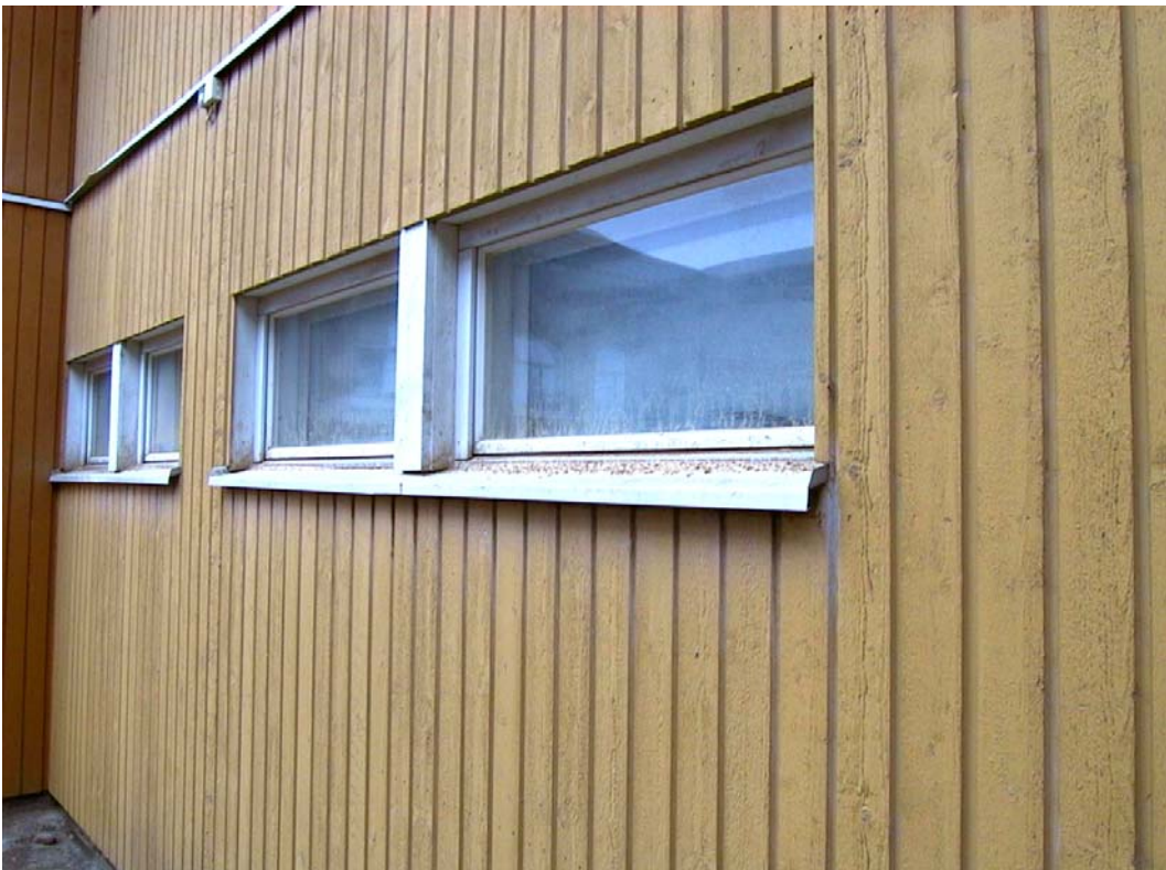
10. Julkisivu pienelementtihallin puruimurin vieressä. Pölyä kertyy todella paljon ikkunapelleille ja myös ikkunan väleihin. Pölyllä on maalipintaa turmeleva vaikutus ulkopuolisiin. Puite on painekyllästetty, mutta pölyn vuoksi maalipinta pysyy lähes jatkuvasti kosteana.
