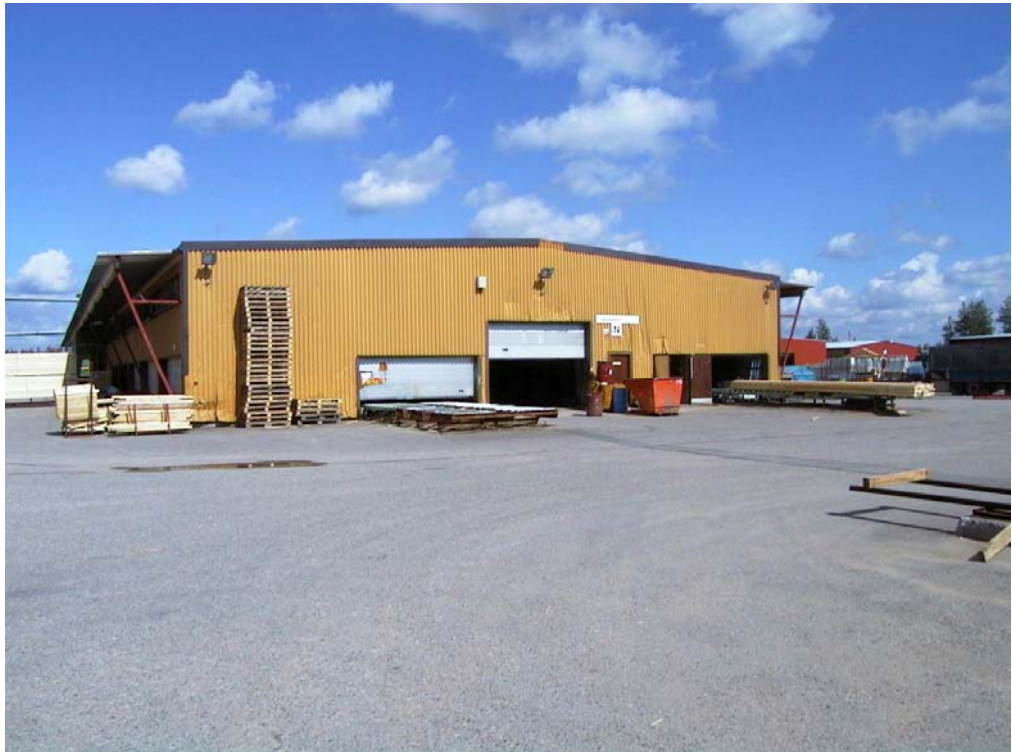
1. Julkisivu etelään. Pellitykset ovat ovien ympäriltä ruttuiset ja yksi pätkä räystäään reunapeltiä puuttuu.
