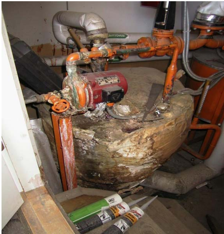
14. Käyttöveden lämmönvaihdin on erittäin huonokuntoinen. Liitosten vesivuodot ovat aiheuttaneet pintakorroosiota useassa kohdassa.
