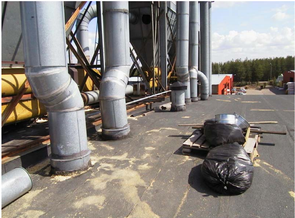
4. Katolla on läpivientejä paljon. Mahdollisia veden vuotopaikkoja on imuriyksikön luona runsaasti.
