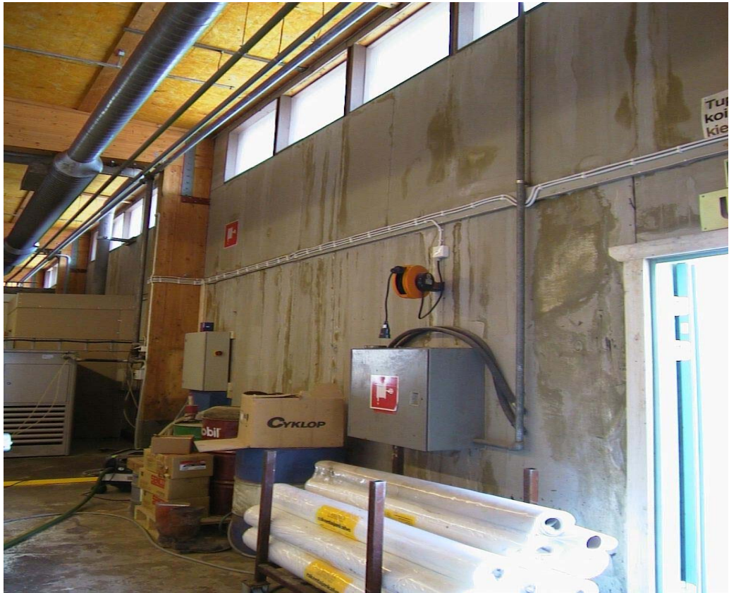
13. Kastunutta seinää nosto-ovelta sähköpääkeskukseen päin.
