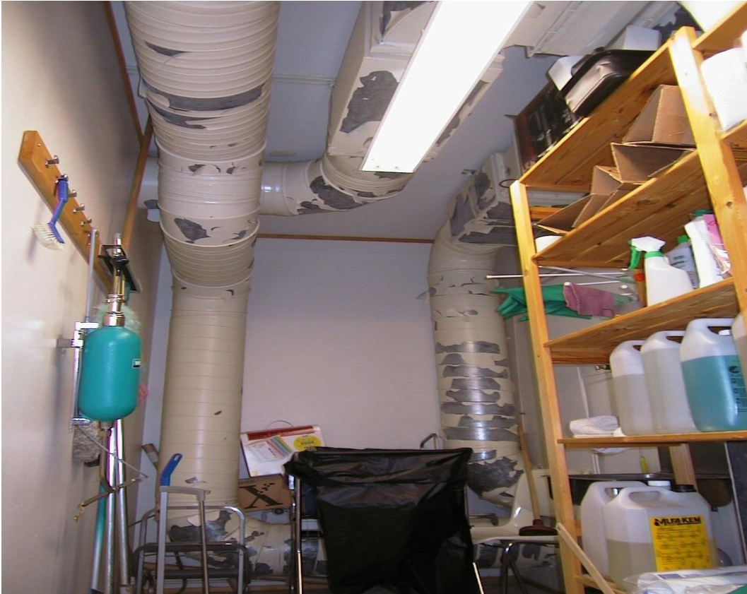
15. Siivouskomerossa on ilmankosteus usein liian suuri, koska ilmanvaihto on puutteellinen ja tilassa kuivataan märkiä luutuja. Tästä on merkinä maalin irtoaminen ilmanvaihtokanavista.
