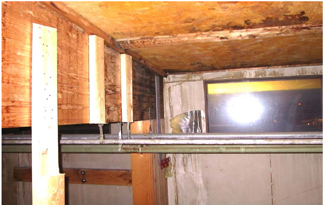
8. Pikkuhöylän vastaanotossa kattoristikon seinän vierus on sinistynyt. Villat ovat veden vaikutuksesta katossa aika kirjavia. Seinän villat olivat kuitenkin kuivia. Hienojakoista pölyä on kulkeutunut alipaineen vaikutuksesta villojen sekaan
