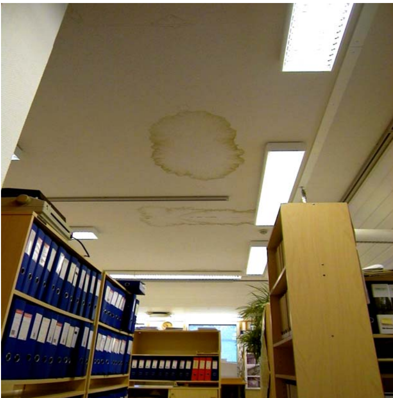
16. Vesikaton paloluukusta on satanut joskus vettä välipohjaan ja kastellut hieman sisäverhouslevyjä.
