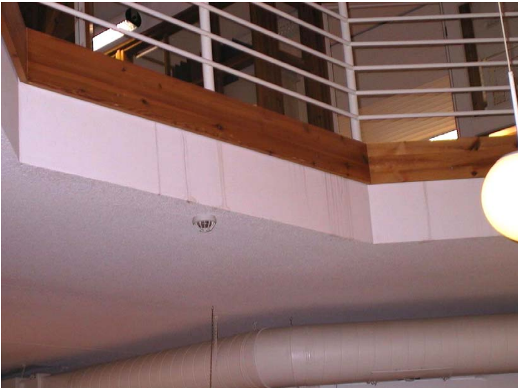
14. Likainen pesuvesi on päässyt valumaan aukonreunoja pitkin pääaulassa.
