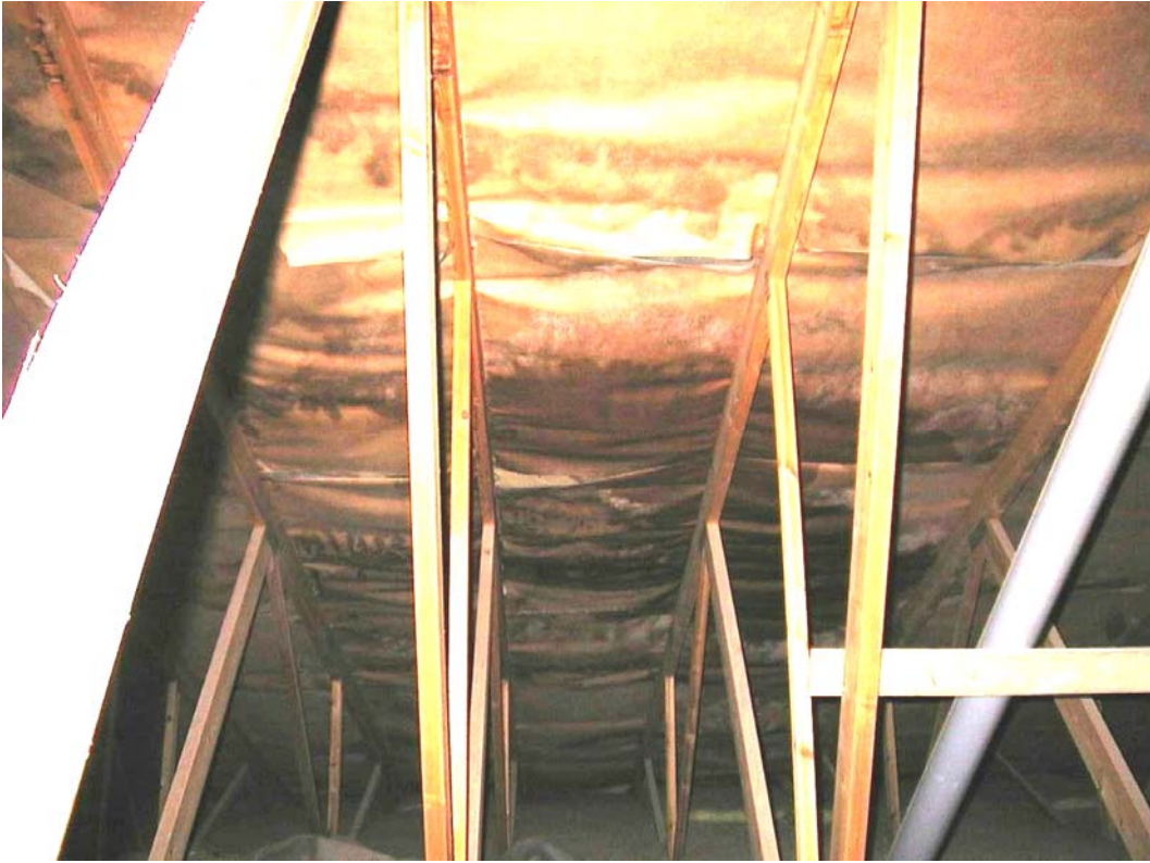
5. Länsi-siiven parkkipaikan puoli on aluskatteen osalta huonokuntoinen.
