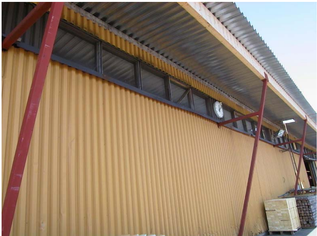
2. Liitoskohta vuotanut uuden ja vanhanlappen välistä. Katolta valuva vesi on lahottanut ikkunan puitteita joistakin kohti täysin.
