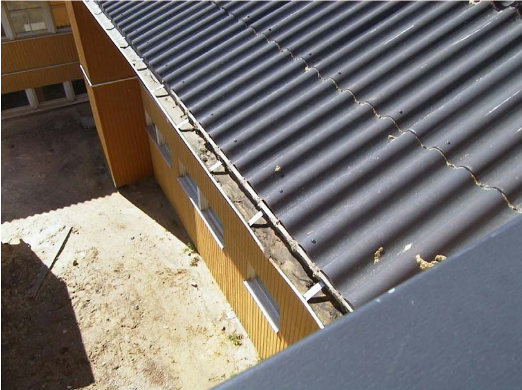
9. Vesikouru on täynnä purua imurien vieressä.
