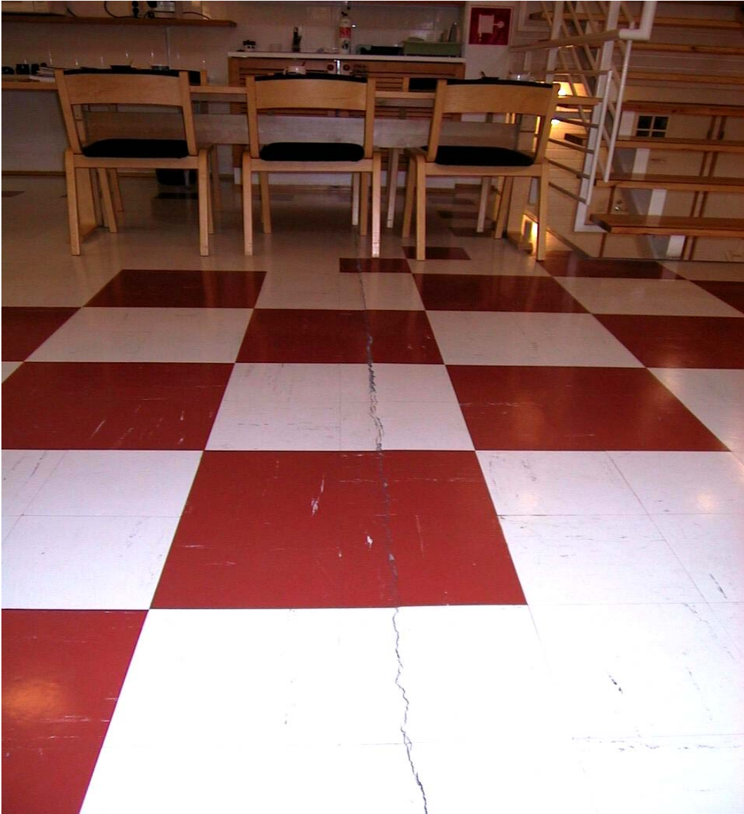
17. Halkeama yläkerran aulan lattiassa. Rakennus on hieman liikkunut keskivaiheilta. Myös pääoven vieressä on halkeama betoni lattiassa (ulkopuolella).
