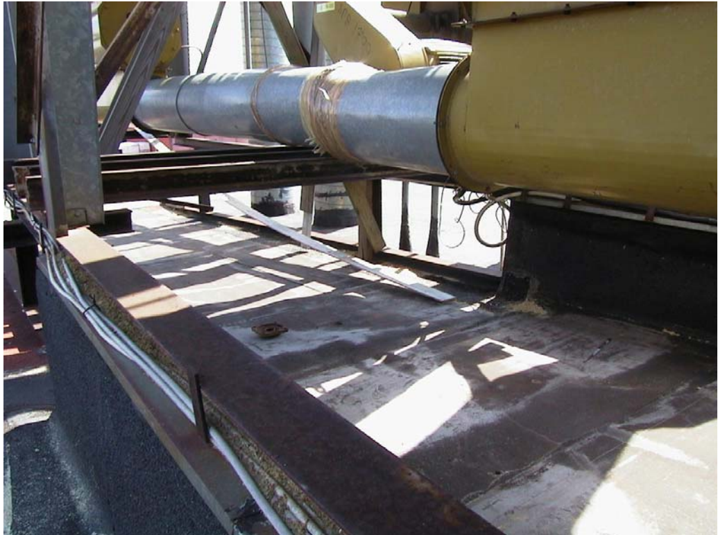
5. Osa imurien alustoista on teräspalkkirakenteisia, joiden vedenpitäväksi tekeminen on ongelmallista.
