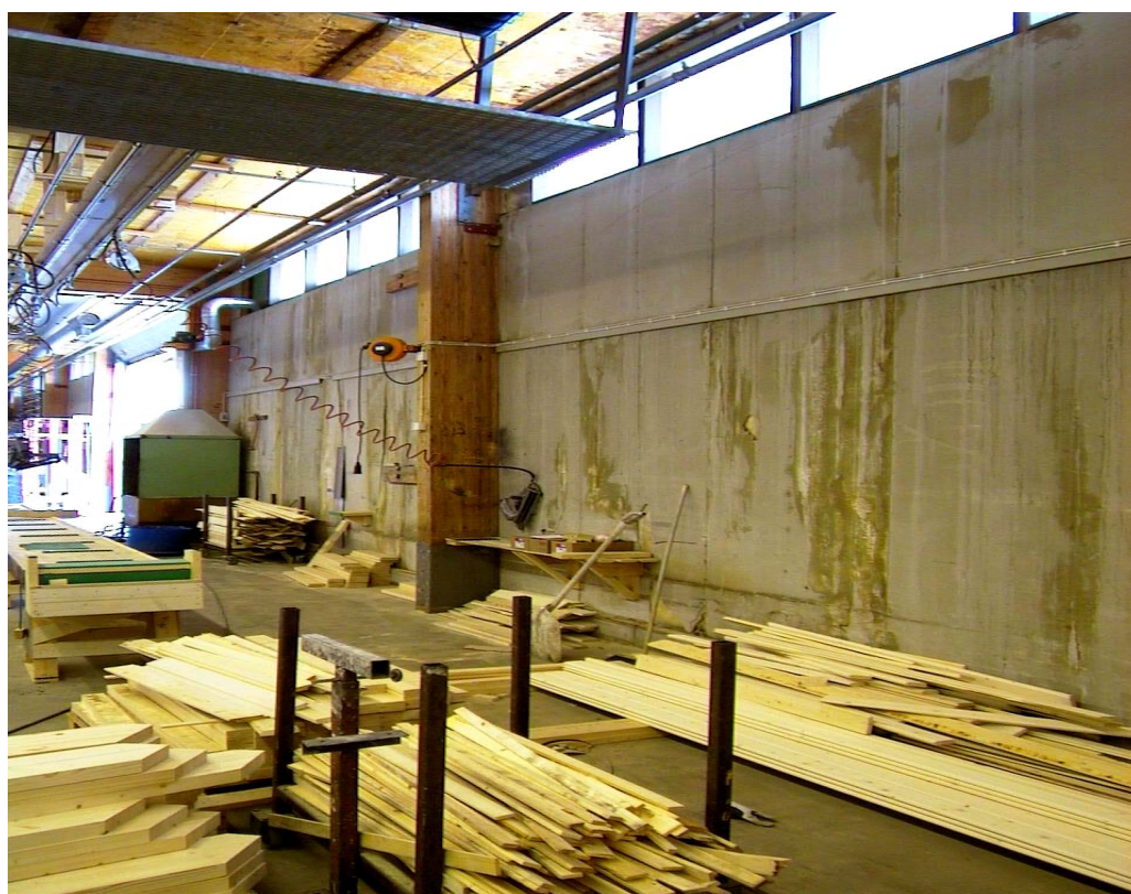
12. Kastunutta itäseinää. Levyt ovat halkeilleet ja pullistuneet seinästä irti.
