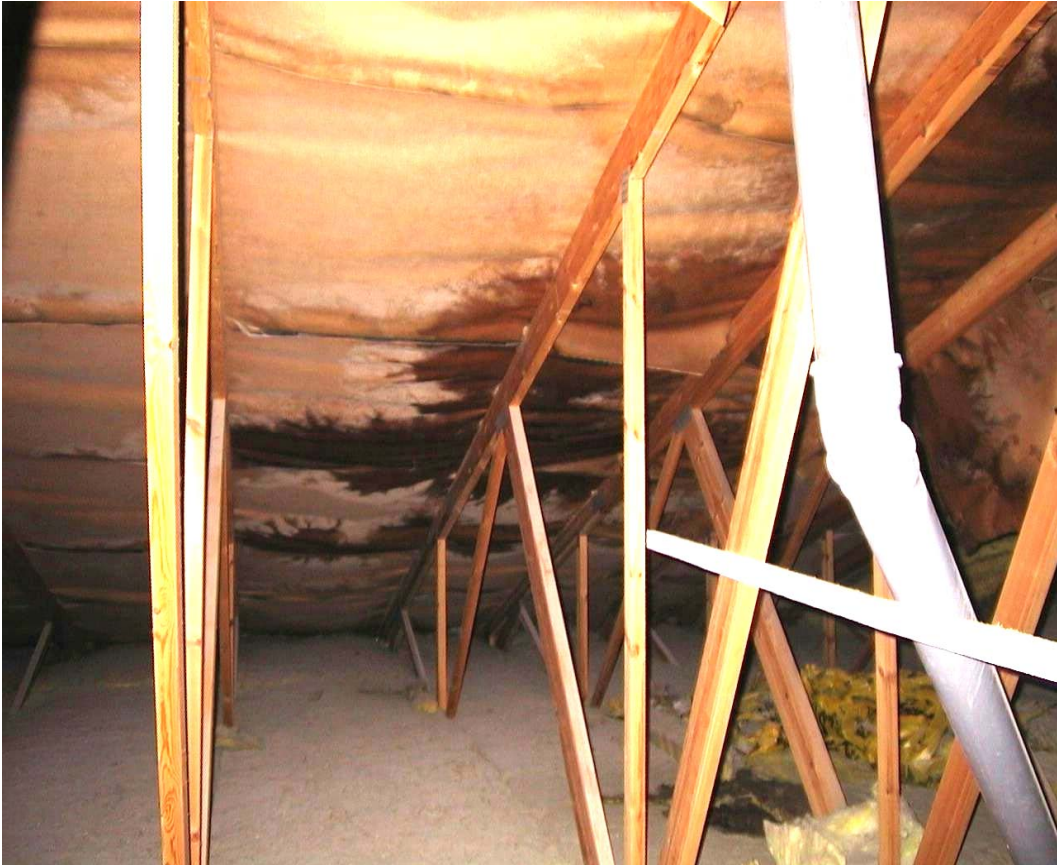
7. Vuotokohta itäsiiven jirissä. Keväisin vuoto on huomattava
