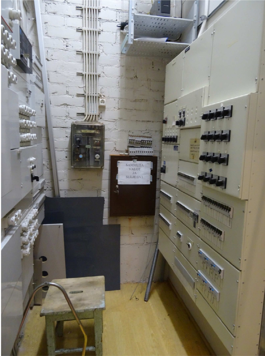
Kuva 12. Ryhmäkeskus RK11 pääkeskushuoneessa pääkeskuksen vastakkaisella puolella.
