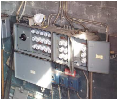
Kuva 15. Ryhmäkeskus RKL lämmönjakohuoneessa.
